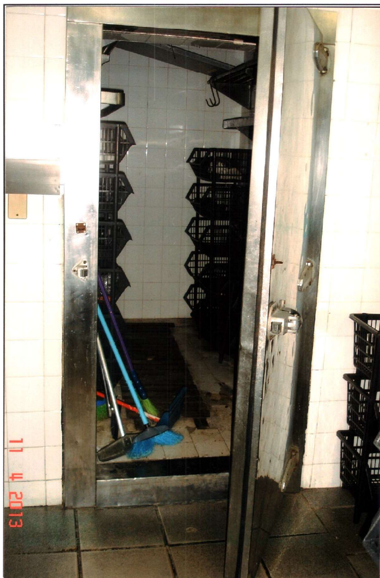
FOTO 12 – Vista da câmara fria industrial localizada na cozinha.
