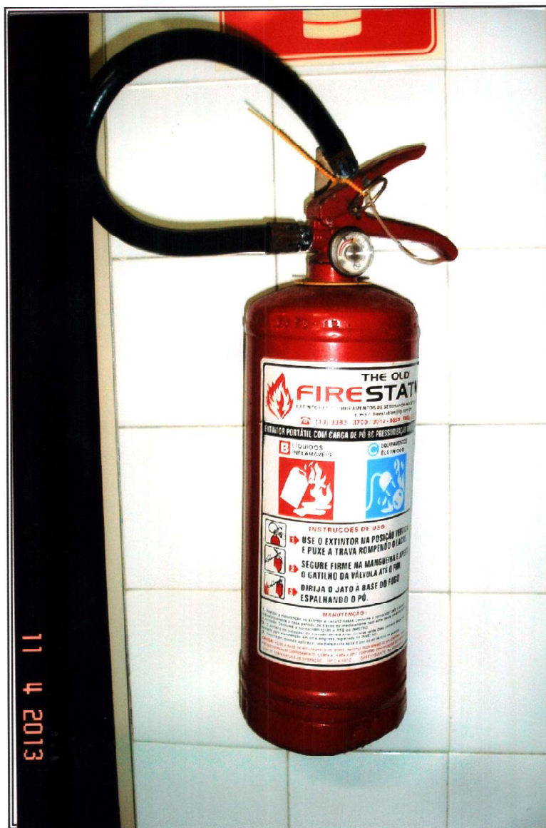
FOTO 16 – Vista do extintor de incêndio localizado na copa.
