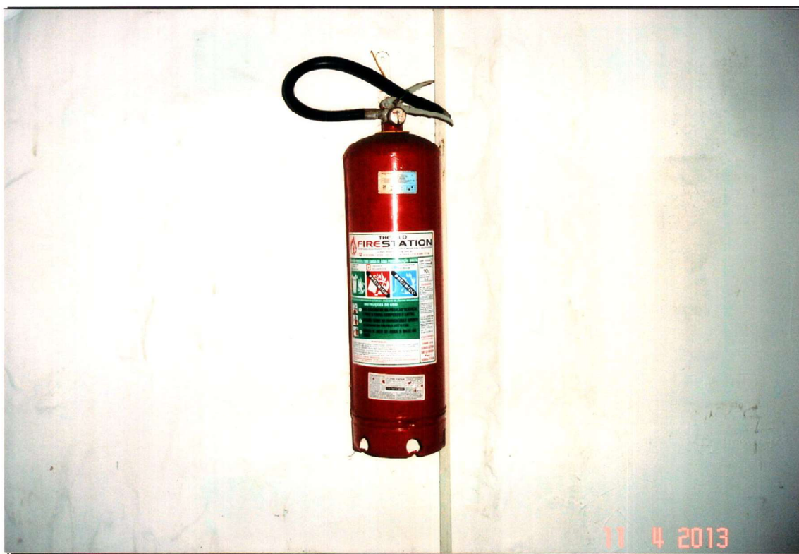
FOTO 29 - Vista de extintor de incêndio localizado próximo à recepção.
