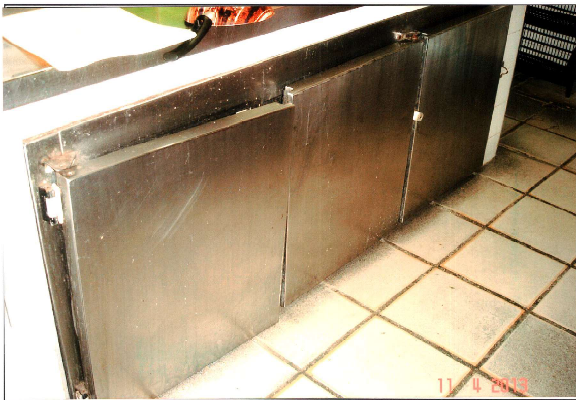
FOTO 15 - Vista de balcão frigorífico horizontal com 3 (três) portas localizado na copa.
