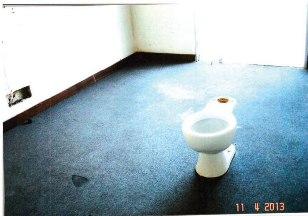
FOTO 137 - Vista de outro quarto do quarto andar podendo se observar, mais uma vez, o estado de conservação do mesmo.
