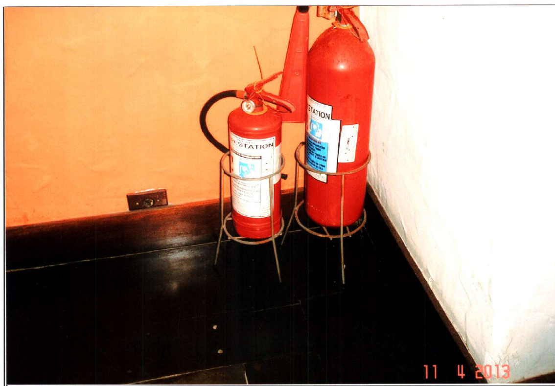
FOTO 30 - Vista de extintores de incêndio próximos ao elevador.
