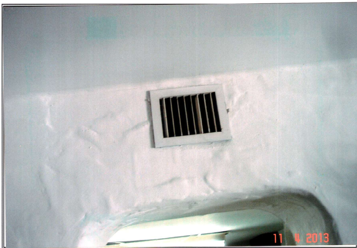
FOTO 26 - Vista da grade de saída do ar condicionado, ar esse que não está funcionando.
