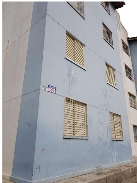
FOTO Nº 2 Vista parcial da lateral do Edifício Trancoso
