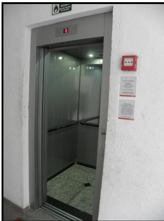
Foto: elevador do bloco 02.
