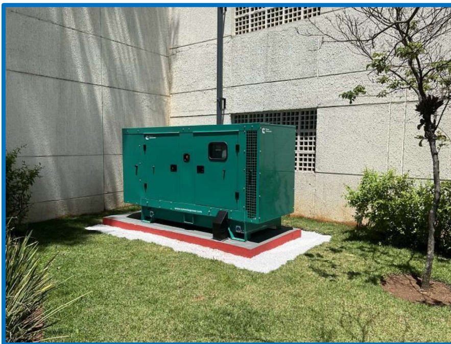
FOTO 24: Gerador de Energia.
