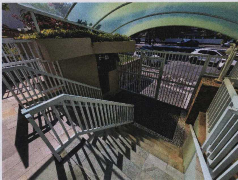
Foto 26 – Vista da escada de acesso para pedestres ao edifício apresentando os seguintes padrões construtivos: piso revestido em pedra mineira; gradis e corrimãos em alumínio; cobertura acrílica.
