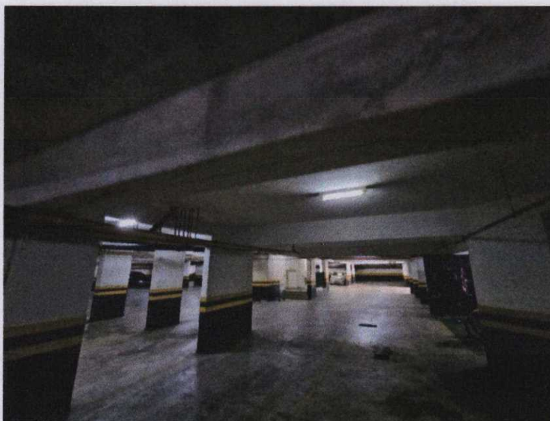
Foto 27 – Vista da garagem do subsolo apresentando os seguintes padrões construtivos: piso cimentado, vigas, pilares, alvenarias e teto revestidos com pintura látex pva acrílica sobre emassamento.
