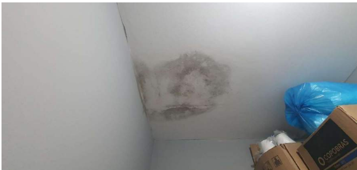
FOTO 93: DEPÓSITO 2, INFILTRAÇÃO DE ÁGUA NO TETO.
