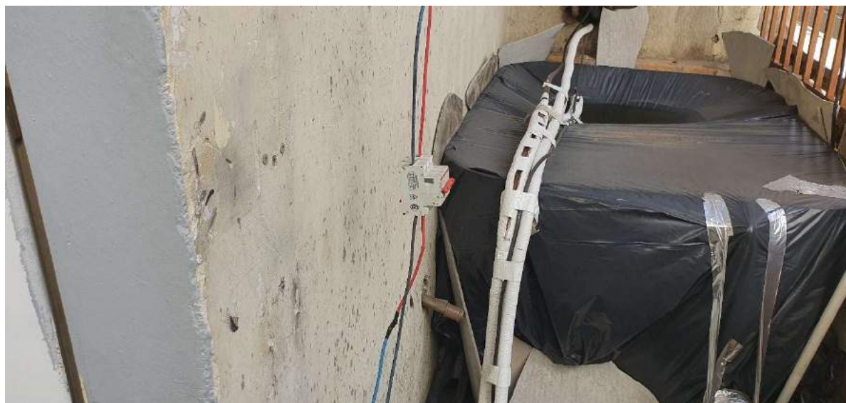
FOTO 98: ÁREA DESCOBERTA, DISJUNTOR E FIAÇÃO EXPOSTOS.
