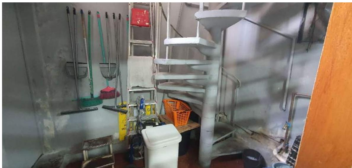
FOTO 83: ACESSO ESCADA, DANOS NA ALVENARIA E ALTERAÇÕES DE HIDRÁULICA EXPOSTAS.
