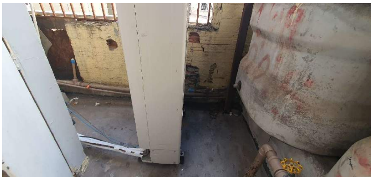
FOTO 100: ÁREA DESCOBERTA, ALVENARIA DANIFICADA, LIGAÇÃO INCORRETA DO AR-CONDICIONADO.
