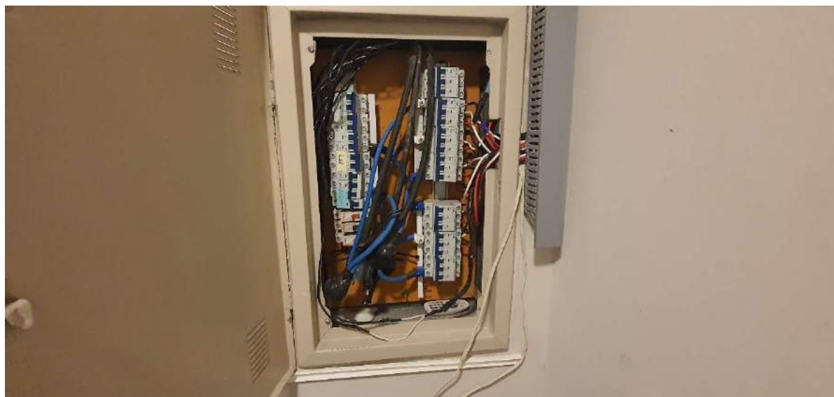
FOTO 51: QUADRO DE FORÇA NA GUARITA, FIAÇÃO EXPOSTA.
