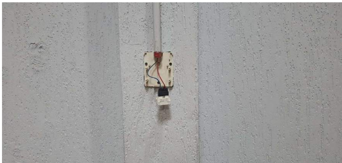
FOTO 22: SALÃO SUPERIOR, TOMADA ELÉTRICA COM FIAÇÃO APARENTE.
