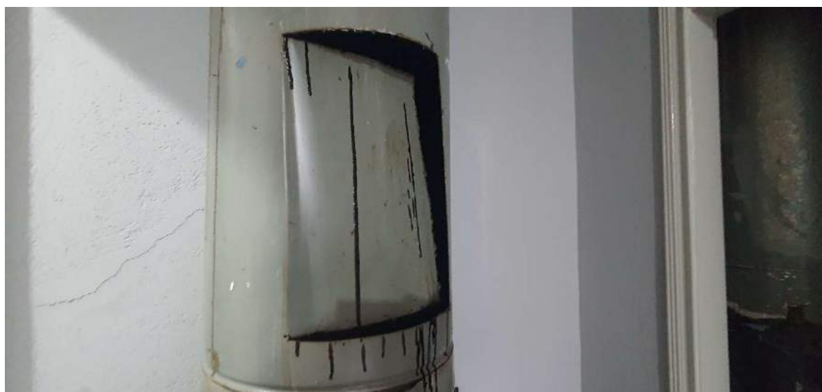
FOTO 89: CIRCULAÇÃO, TUBULAÇÃO CORTADA.
