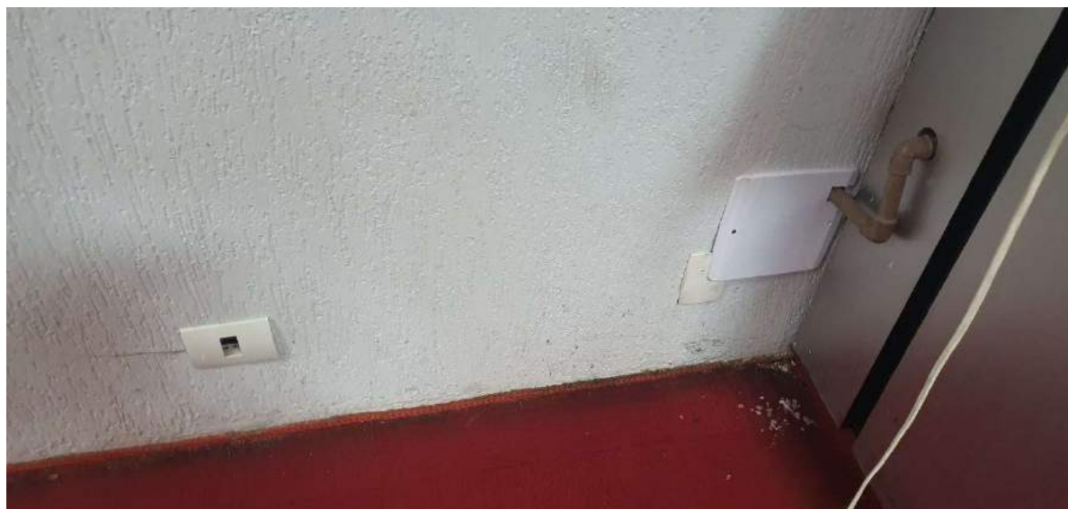
FOTO 23: SALÃO SUPERIOR, A ESQUERDA, ACABAMENTO SEM TOMADA, A DIREITA TUBULAÇÃO HIDRAULICA EXPOSTA.
