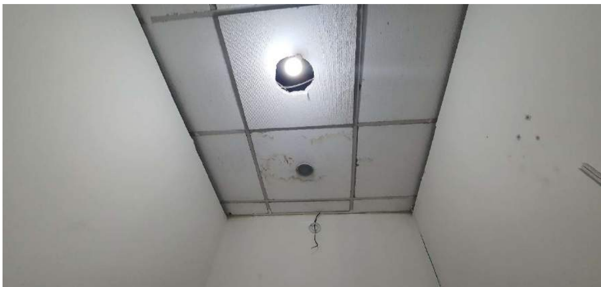
FOTO 41: DEPÓSITO 4, ILUMINAÇÃO IMPROVISADA, INFILTRAÇÃO E FURO NO TETO, FIAÇÃO EXPOSTA.
