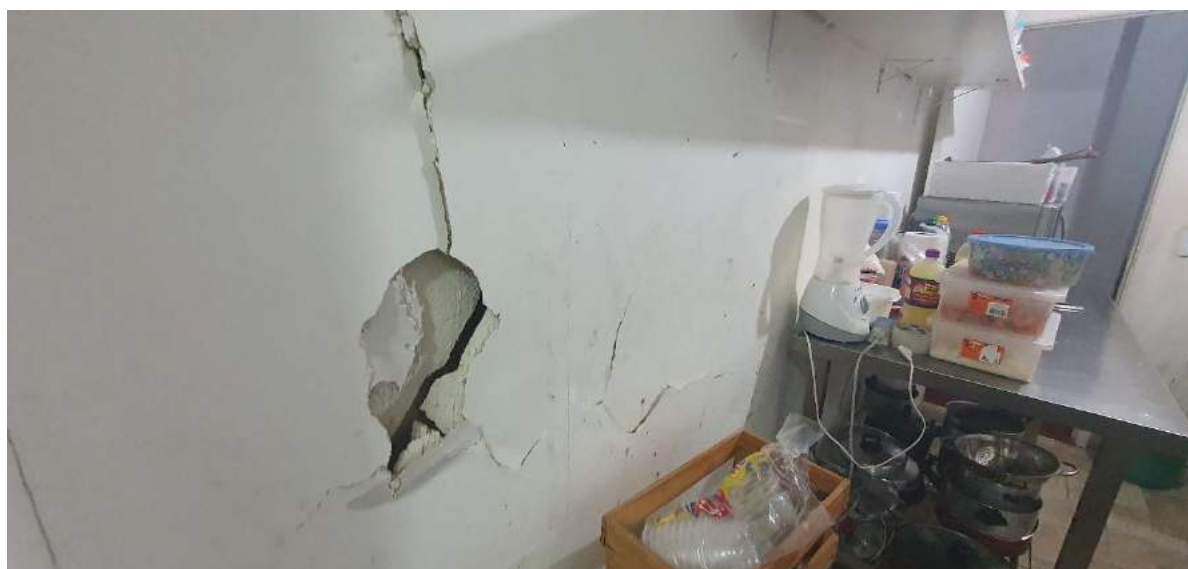
FOTO 38: COZINHA, DANOS NA PAREDE DE DRY-WALL.
