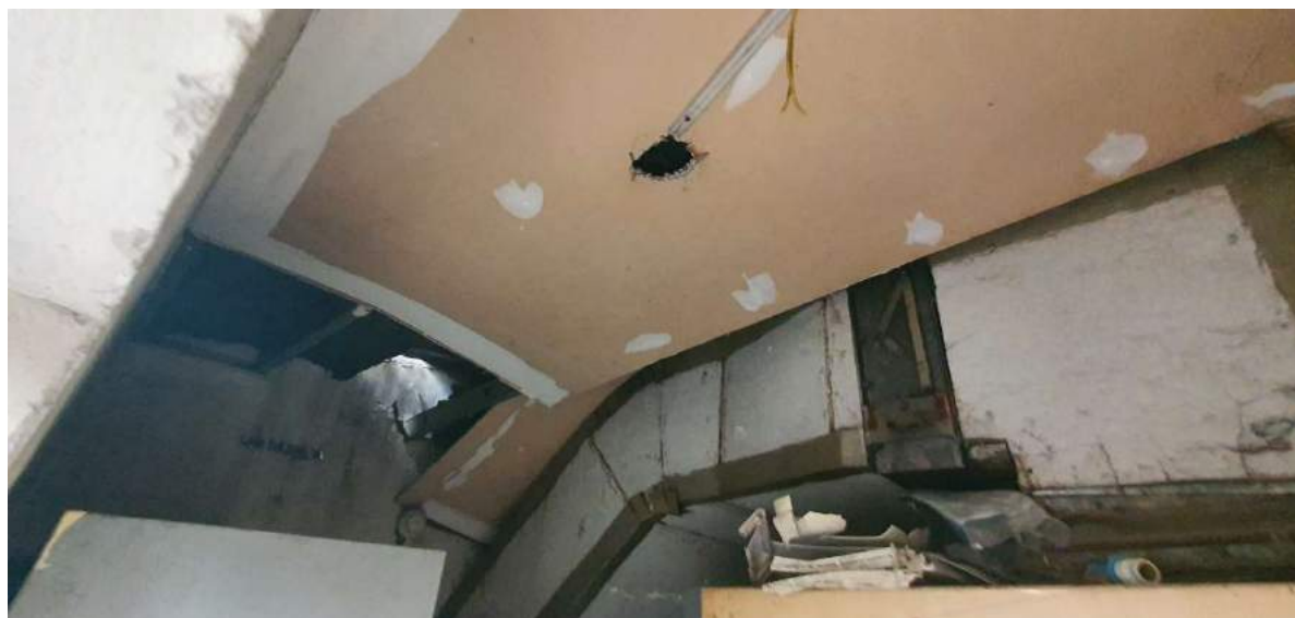
FOTO 105: SALA DO AR-CONDICIONADO, SEM ILUMINAÇÃO ELÉTRICA, TETO COM PERFURAÇÃO.
