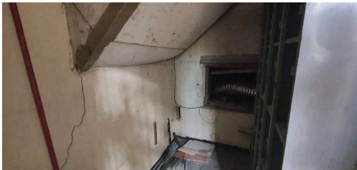
FOTO 104: SALA DO AR-CONDICIONADO, CONTINUAÇÃO, TRINCA NA ALVENARIA.
