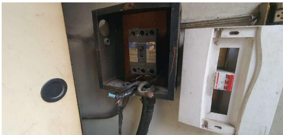
FOTO 103: SALA DO AR-CONDICIONADO, QUADRO DE FORÇA COM FIAÇÃO EXPOSTA, SEM TAMPA E SEM IDENTIFICAÇÃO.
