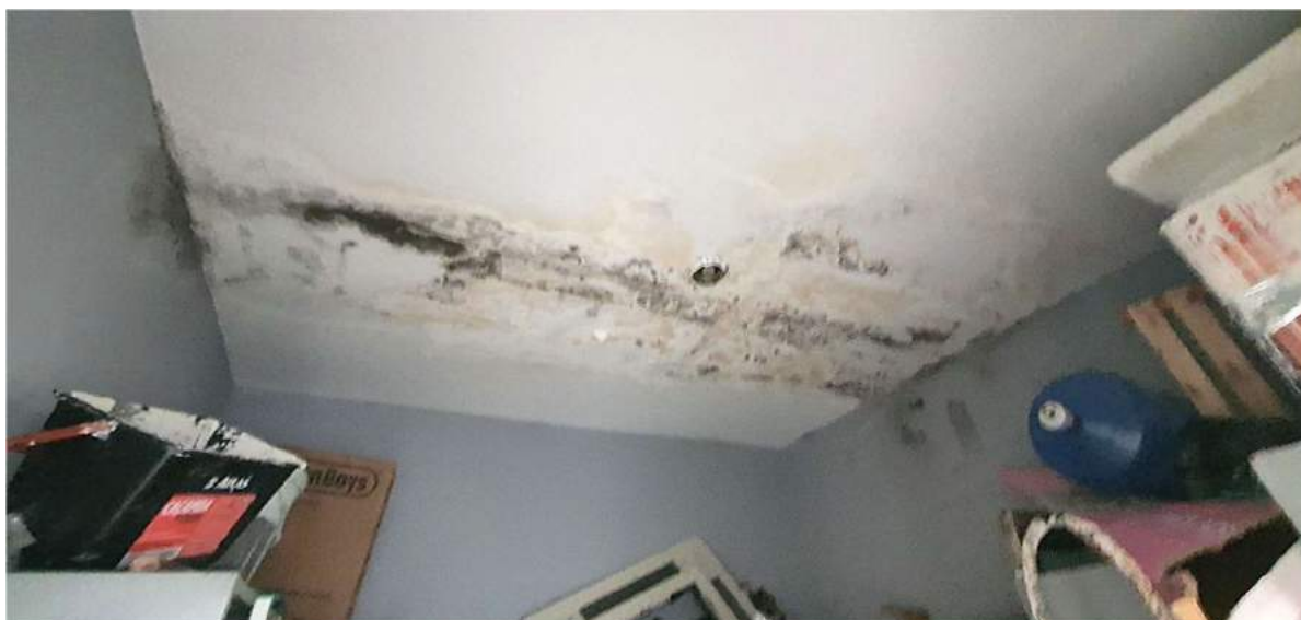
FOTO 95: DEPÓSITO 3, INFILTRAÇÃO DE ÁGUA NO TETO, SEM ENERGIA ELÉTRICA.
