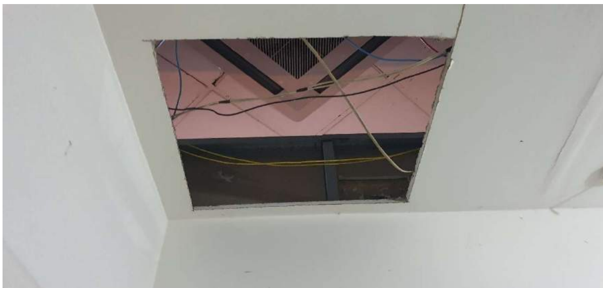
FOTO 44: NA PASSAGEM DA COZINHA PARA DESPENSA, FURO EVIDENCIA FIAÇÃO EXPOSTA.
