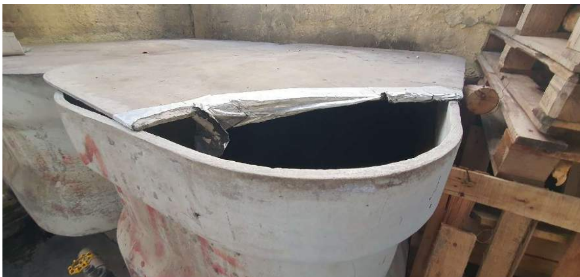
FOTO 101: ÁREA DESCOBERTA, TAMPA DA CAIXA D'ÁGUA DANIFICADA.
