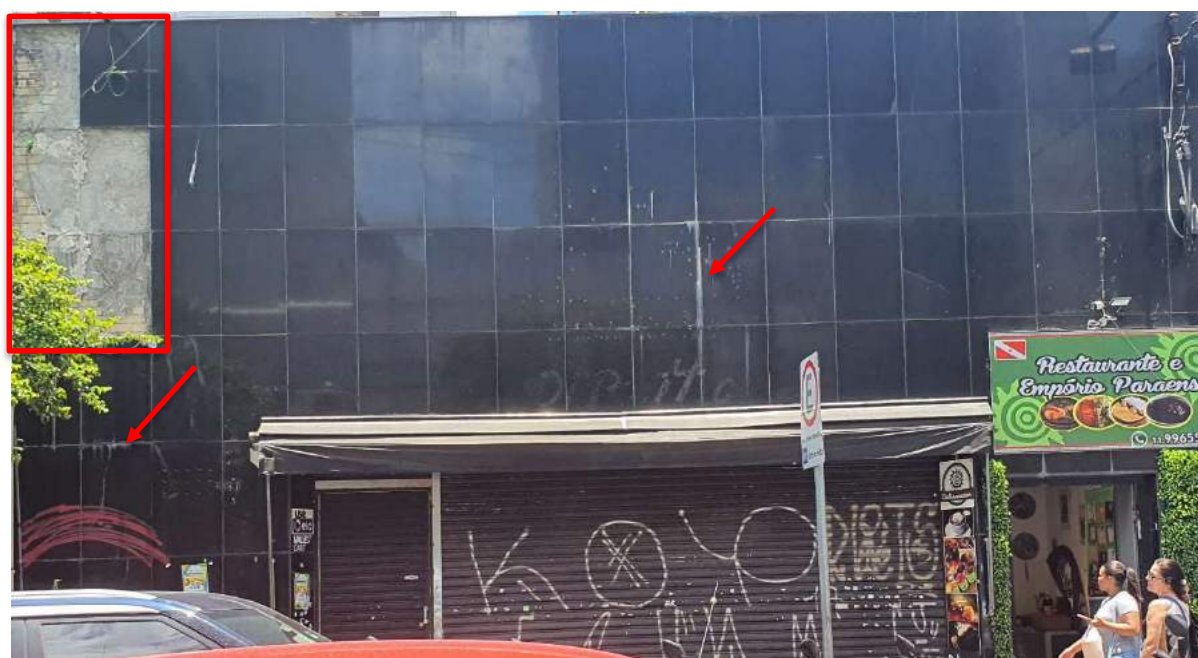
FOTO 04: VISTA DA PORTA DE ENTRADA DO IMÓVEL OBJETO DA PRESENTE AÇÃO, EM DESTAQUE, INTERCORRÊNCIAS NA FACHADA.
