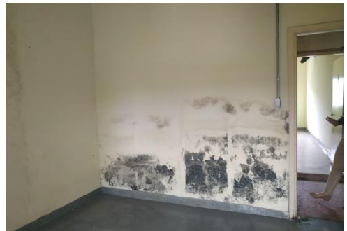
Dormitório 24 parede infiltrada
