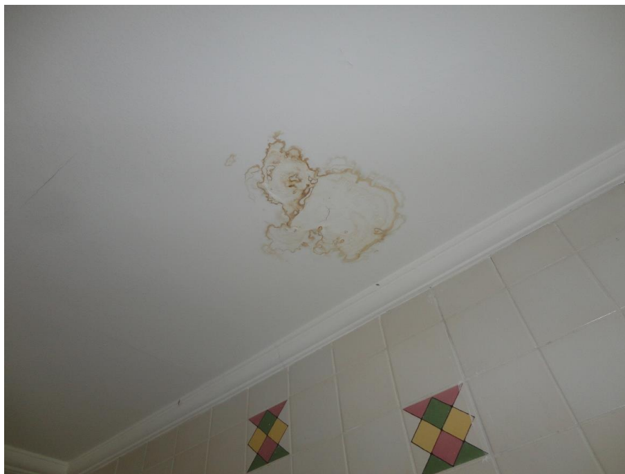
FOTO 28 - Manchas de umidade no forro.
