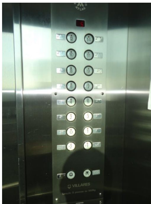
FOTO 03 – Painel do elevador (sem a presença do 13º andar)
