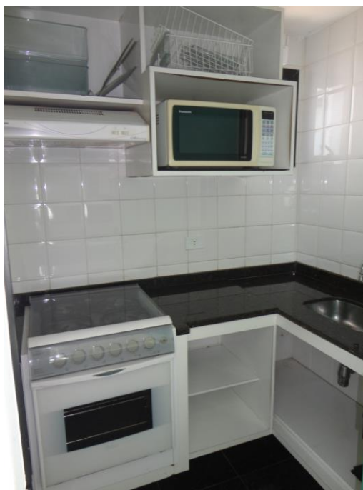
FOTO 41 - Vista geral da cozinha do salão de festas.
