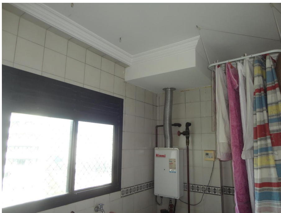
FOTO 11 - Vista geral da área de serviço com aquecedor a gás.
