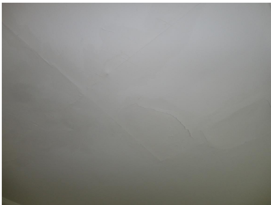
FOTO 27 - Pequenas fissuras com infiltração no forro.
