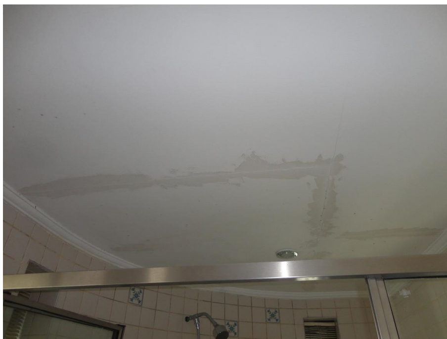
FOTO 31 - Manchas de umidade no forro.
