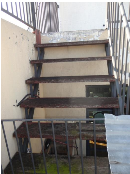
FOTO 18 - Escada de acesso em mau estado.
