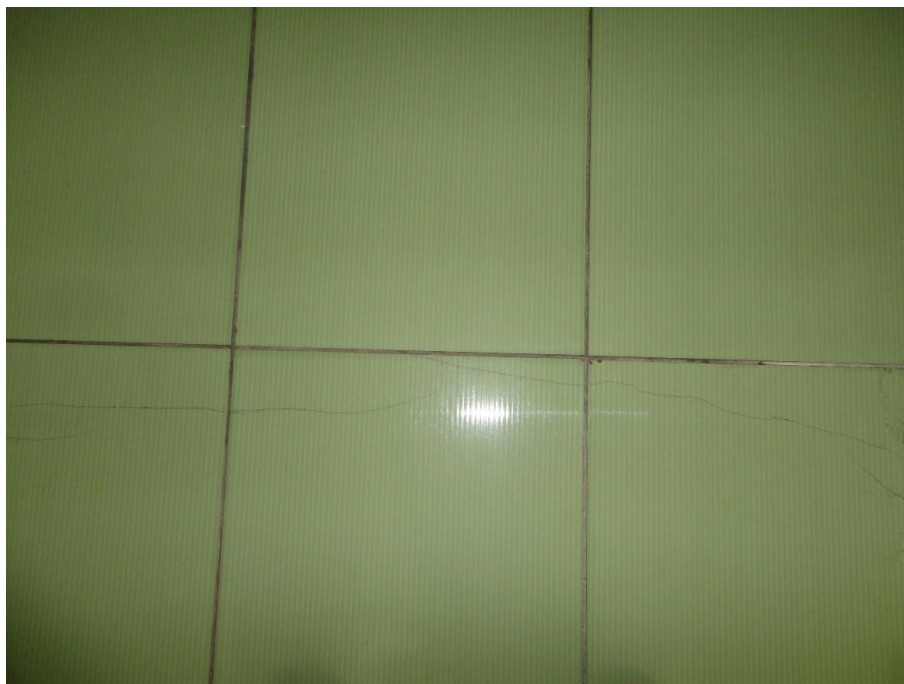
FOTO 26 - Pequenas fissuras no piso em azulejo verde.
