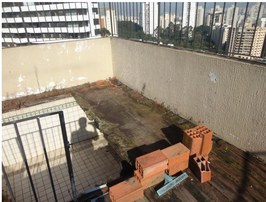
FOTO 16 - Vista geral da área externa do 14º andar (estado ruim de conservação).
