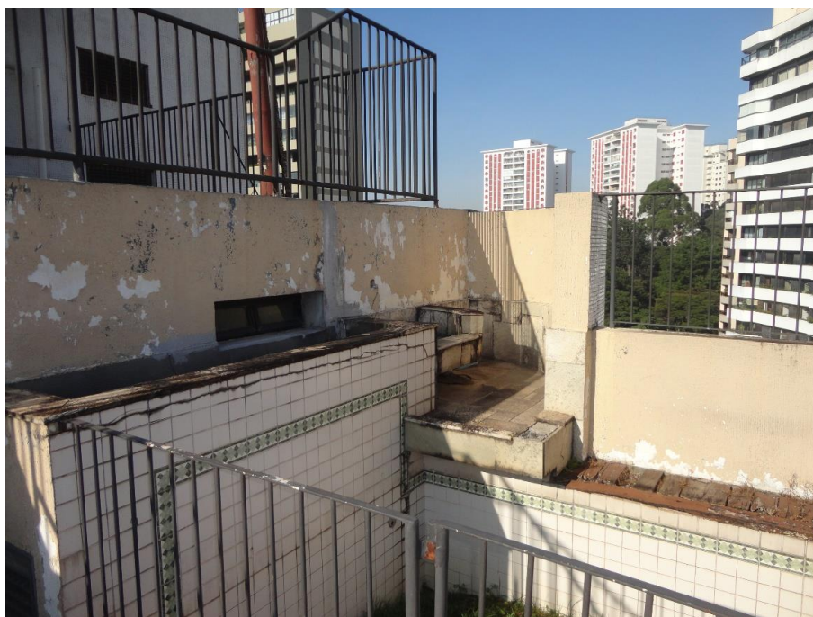
FOTO 15 - Vista geral da área externa do 14º andar (estado ruim de conservação).
