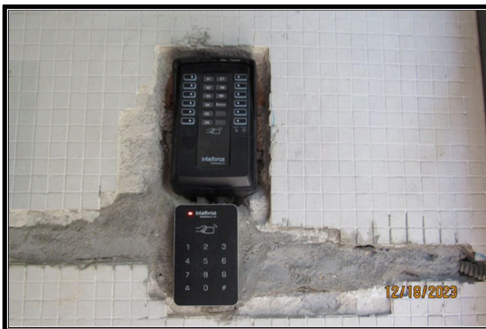
INTERFONE E SISTEMA DE ACESSO AO CONDOMÍNIO
