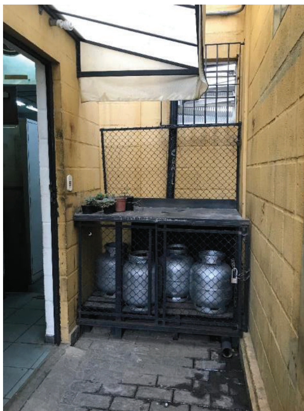
Foto 44: Abrigo de gás no pavimento térreo.
