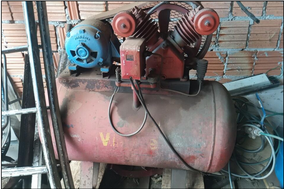
ITEM 0002 - COMPRESSOR DE AR
