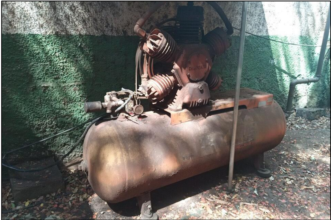
ITEM 0061 - COMPRESSOR DE AR
