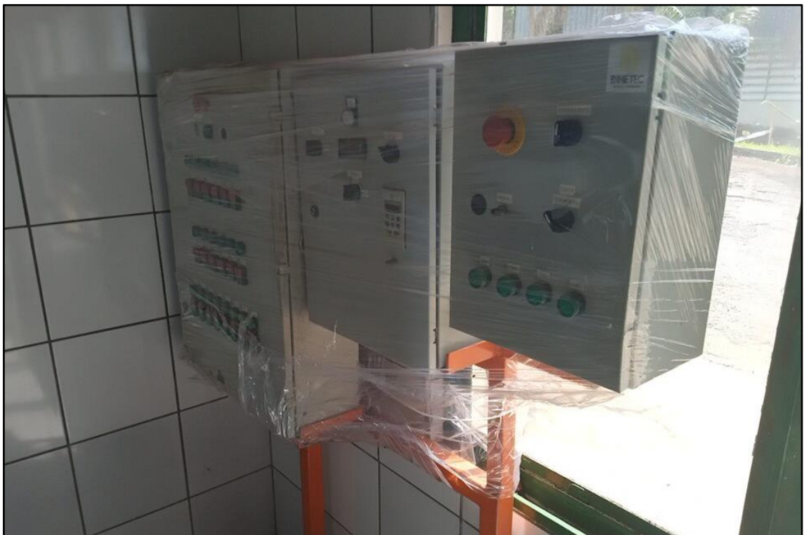
ITEM 0078 - PAINEL ELÉTRICO
