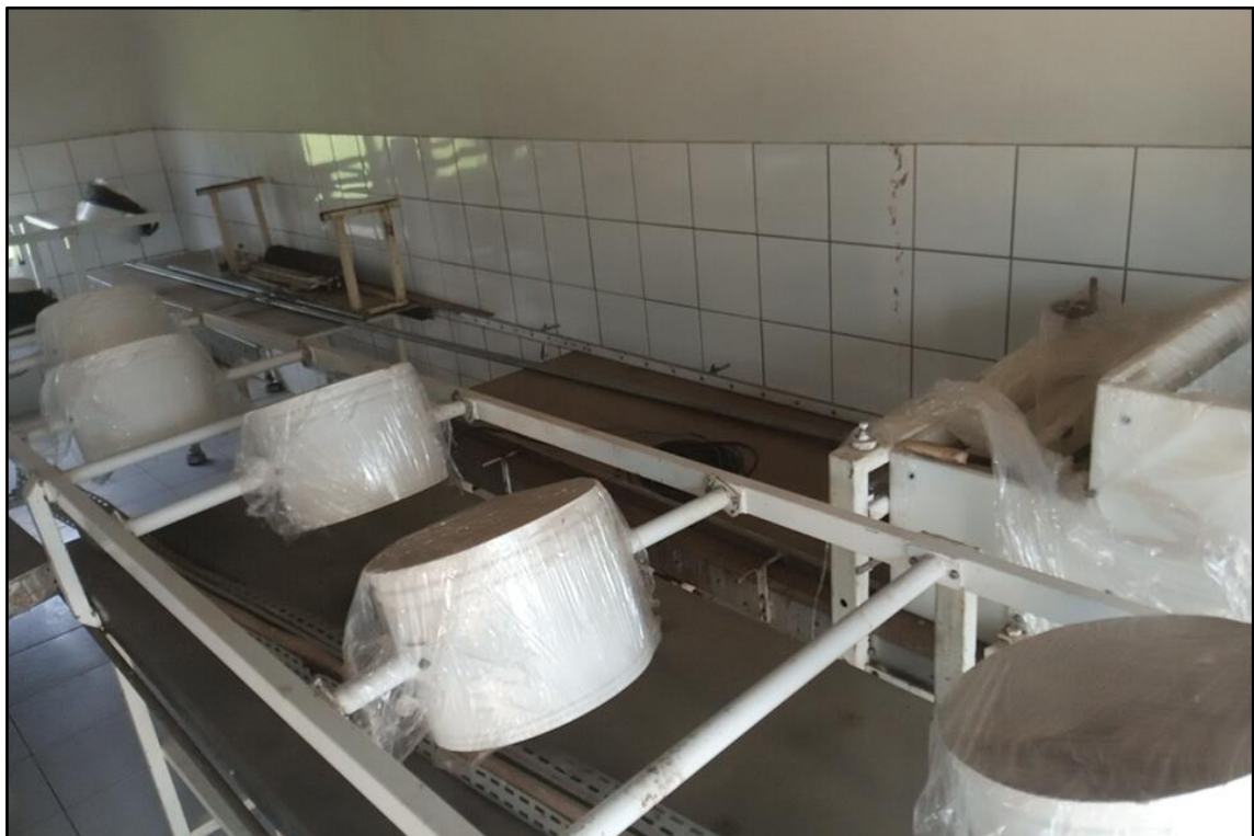
ITEM 0076 ESTEIRAS REFRIGERADORAS
