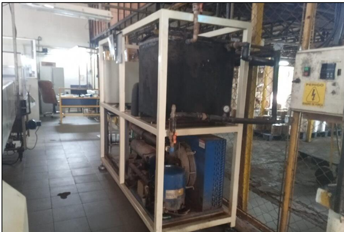
ITEM 0017 - MÁQUINA DE REFRIGERANTE R22
