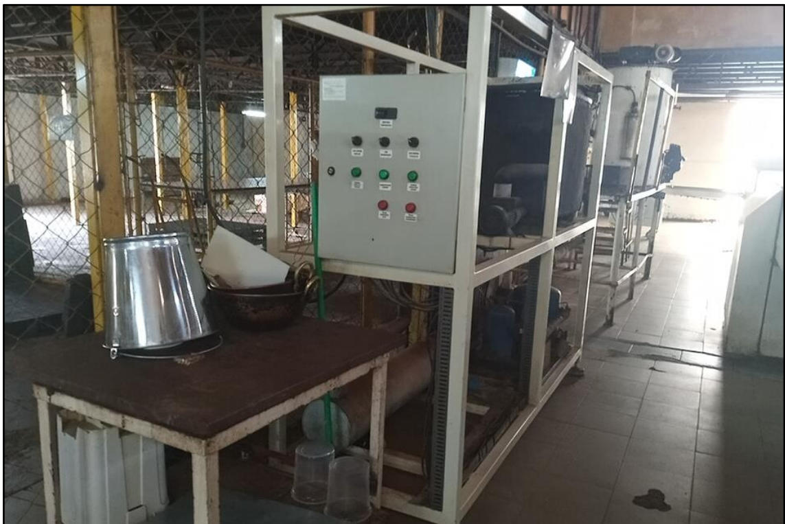
ITEM 0017 - MÁQUINA DE REFRIGERANTE R22
