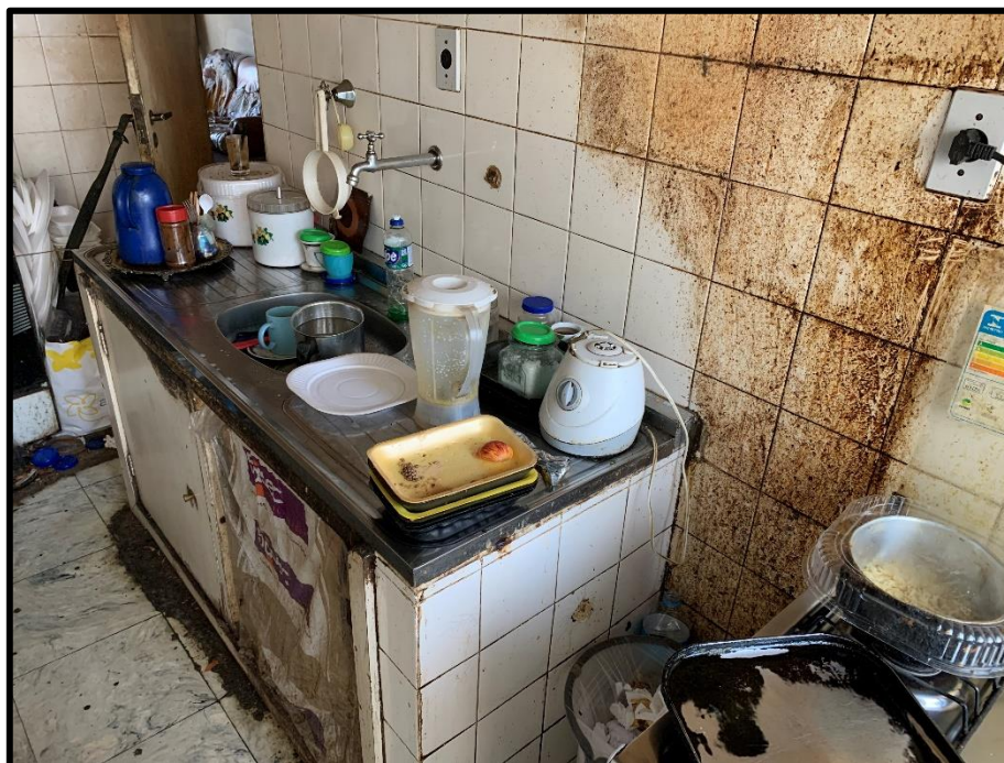
Figura 19 – Cozinha com detalhe da deterioração
