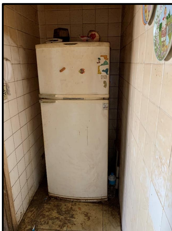
Figura 20 – Cozinha com detalhe da deterioração
