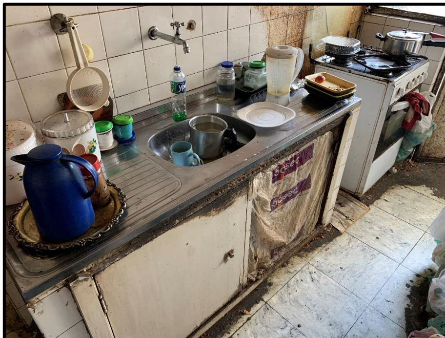
Figura 15 – Cozinha com detalhe da deterioração
