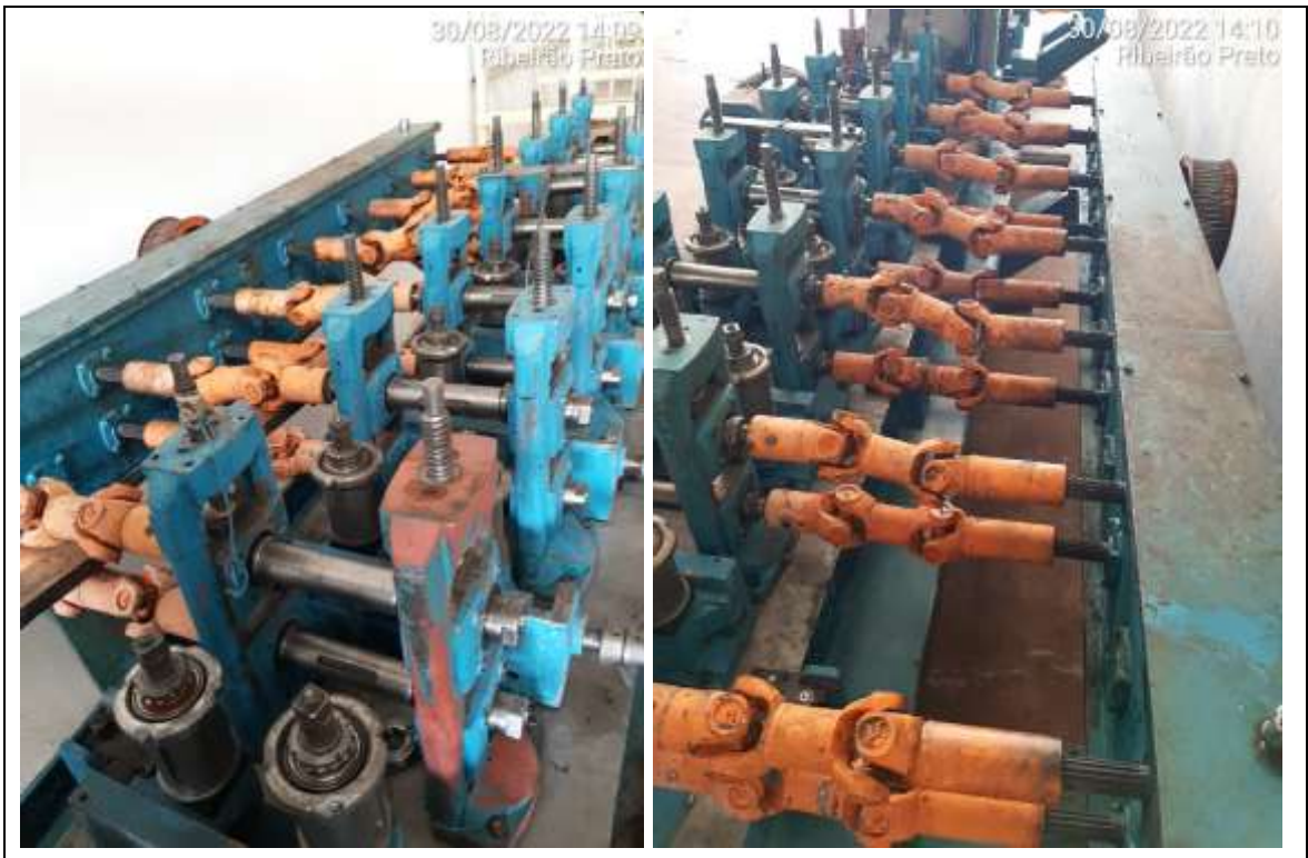
Fotos 07 e 08 – Estrutura relativa à entrada de matéria prima Fita de Aço para início do processo contínuo de conformação à frio, constando 07 mancais de posicionamento dos conjuntos de Rolos Conformadores (foto 07), acionados por motor elétrico marca WEG, desacoplado da máquina, e conjuntos de cardans (foto 08).
