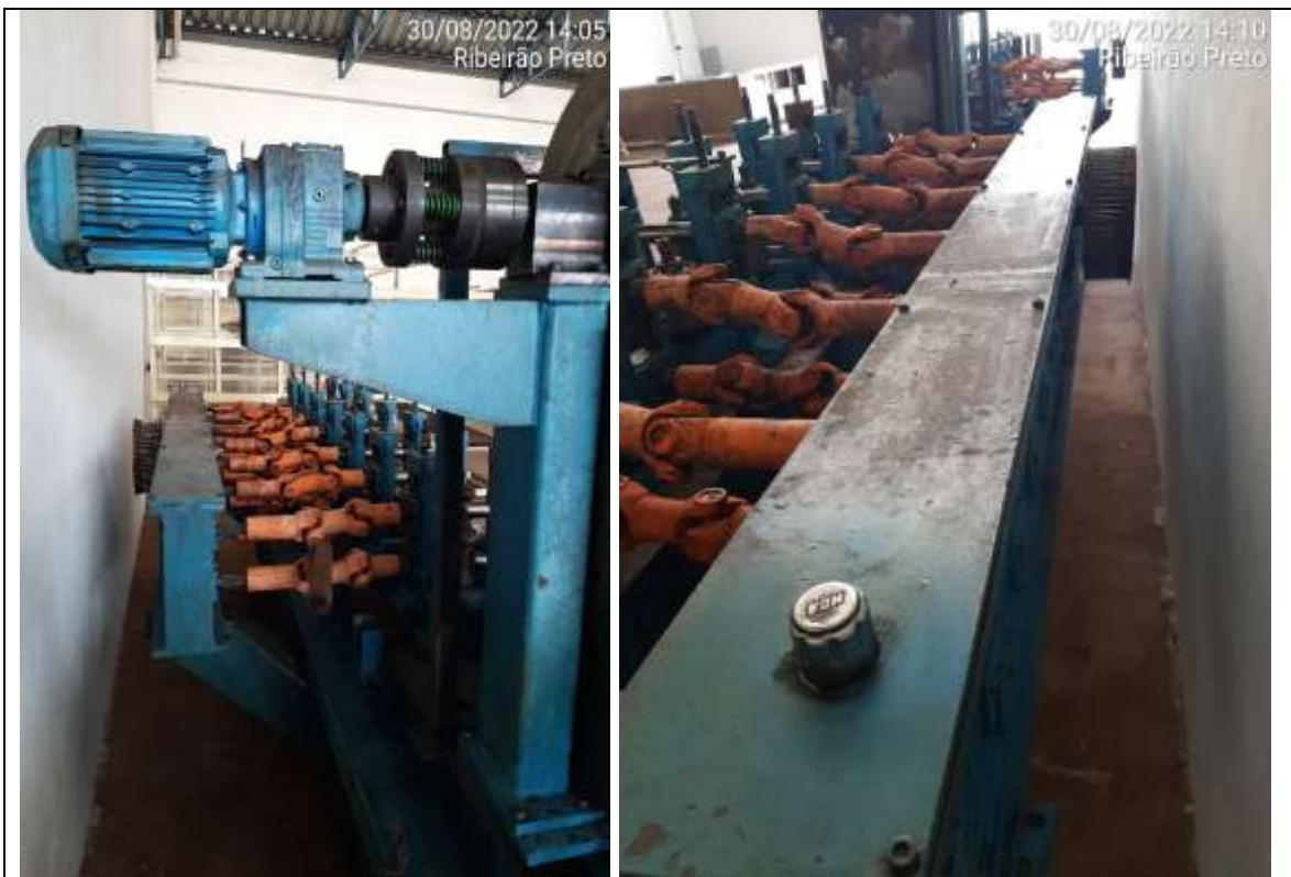
Fotos 11 e 12 – Vistas posteriores da máquina com o motoredutor do Rebobinador do Refilo (foto 11) e acoplamento do motor elétrico marca WEG que aciona os cardans dos Rolos Conformadores.
