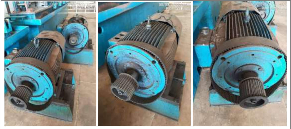
Fotos 04 a 06 – Imagens dos 02 Motores Elétricos marca WEG, potência estimada de 75 cv cada, desacoplados da máquina. Estes motores são responsáveis pelos acionamentos dos Conjuntos de Cardans que por sua vez acionam os Rolos Conformadores e os Rolos Caibradores.
