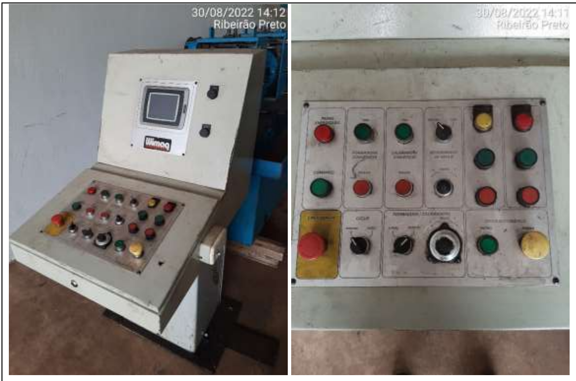
Fotos 17 e 18 – Painel Elétrico de Comando e Controle.
