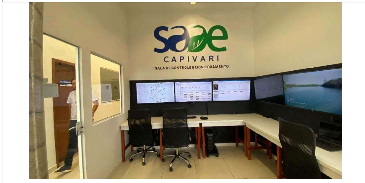
SALA DE MONITORAMENTO.
