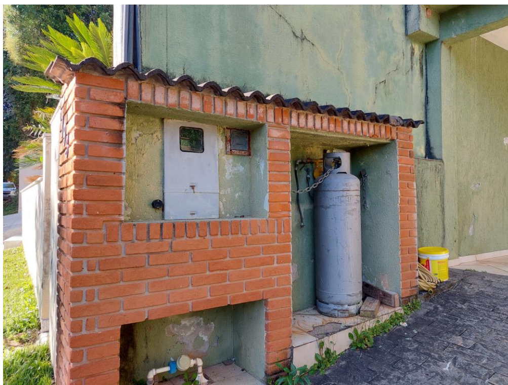
Vista das entradas de energia, gás e água.
