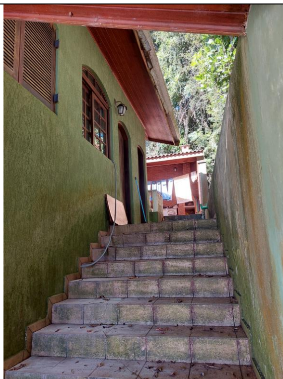
Escada de acesso à edícula e quintal. O beiral da casa também apresenta sinais de infiltração.
