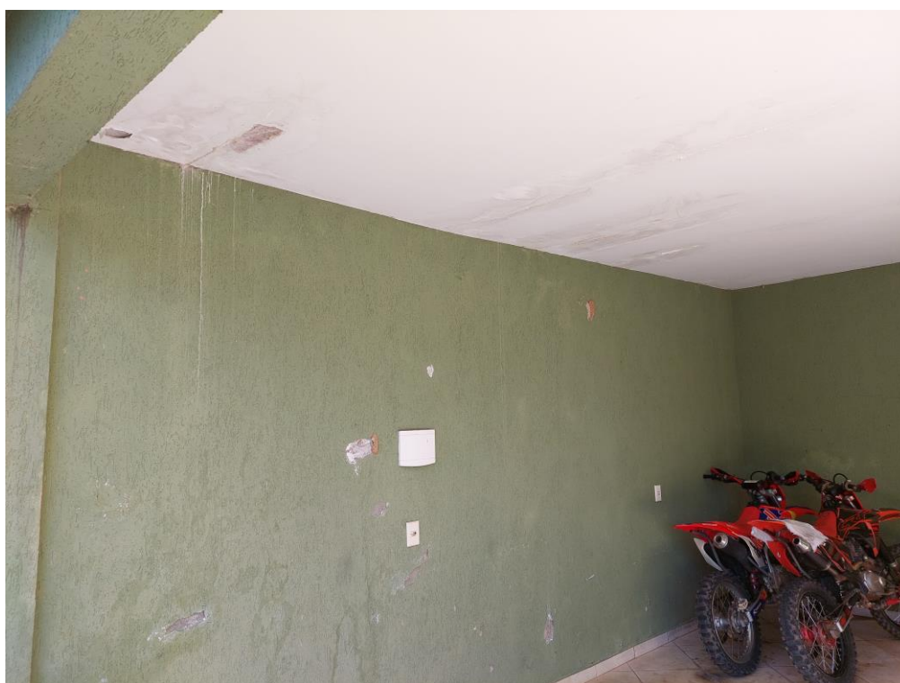
Sinais de infiltração no teto da garagem.
