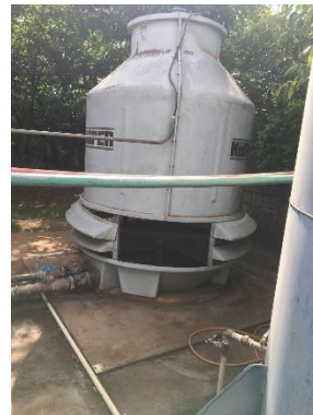
- refrigeradores de água
