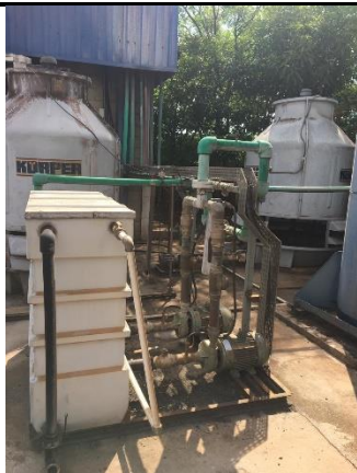
- refrigeradores de água -
