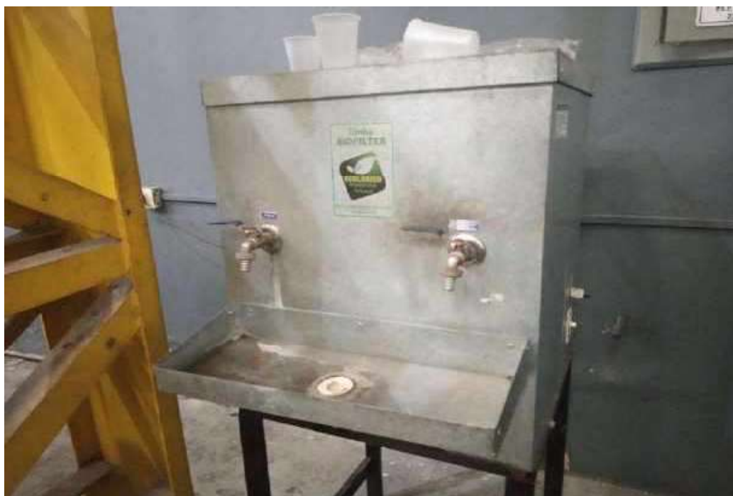
ITEM 2,017 - VISTA DO BEBEDOURO INDUSTRIAL 2 TORNEIRAS
