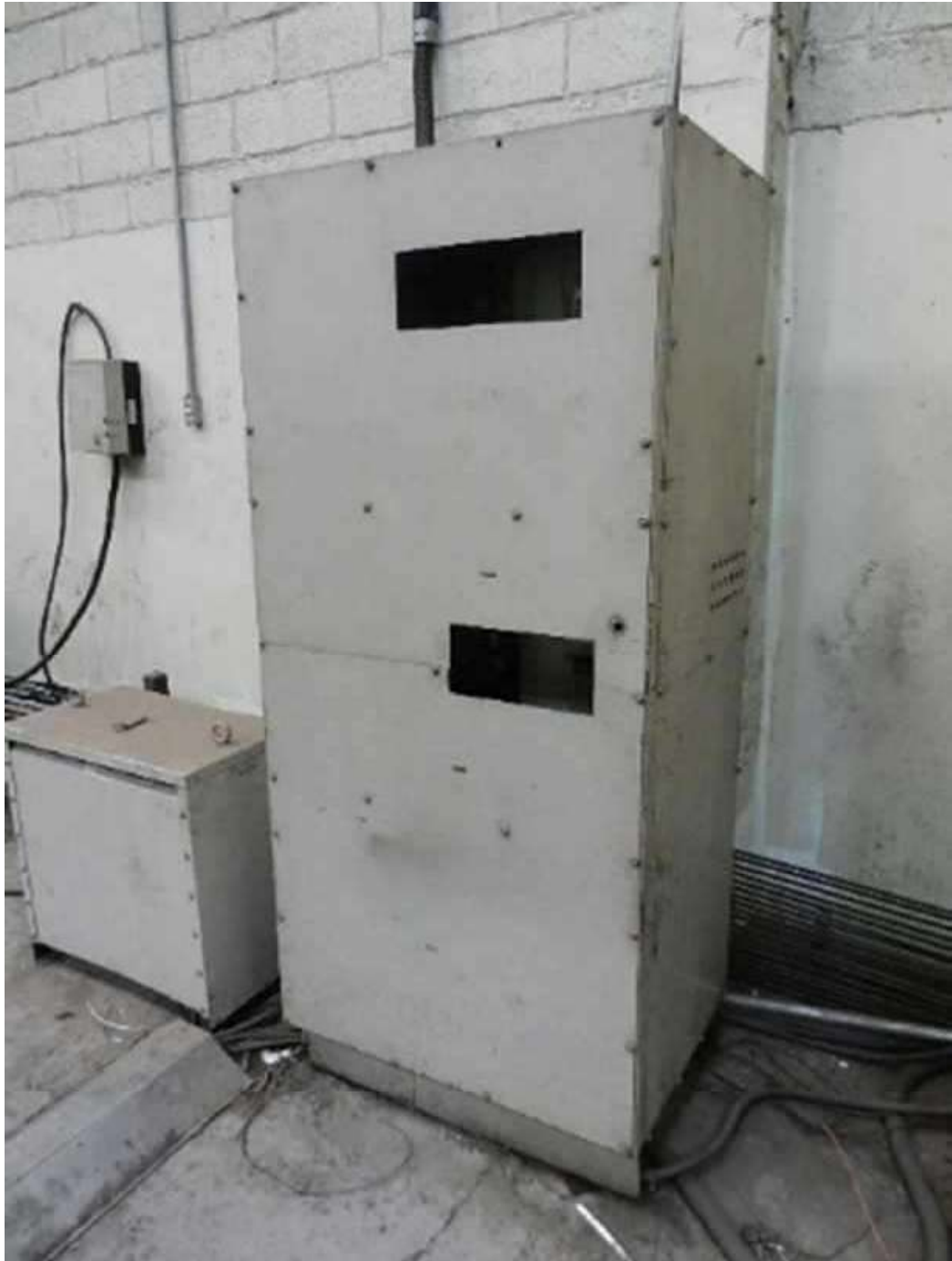
ITEM 1,026 - VISTA DO PAINEL ELETRICO COM 2 INVERSORES DE FREQUÊNCIA
