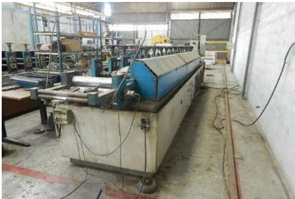
ITEM 1,008 - VISTA DA MÁQ Nº 1 – DESBOBINADOR COM MOTOR E REDUTOR E PERFILADEIRA COM 14 CASTELOS
