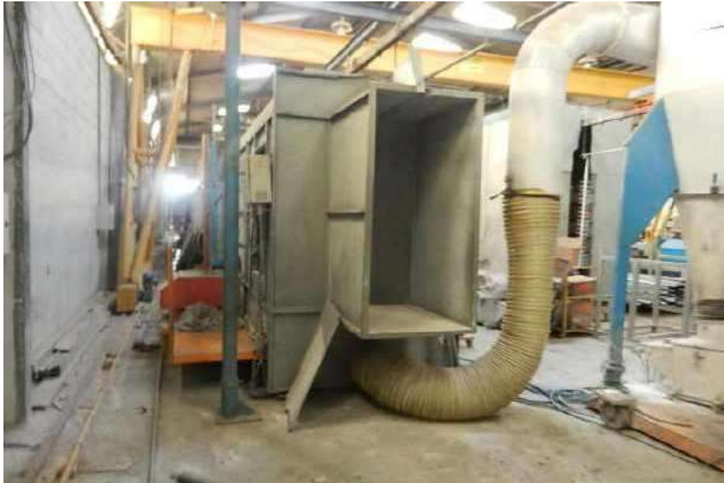
ITEM 1,038 - VISTA DA CABINE DE PINTURA MODELO: CPPE-ACGFD Nº 2367-003 DIM: 1.600 X 700 MM COM 4 BICOS MODELO: AUTOPLUS DA LINHA DE PINTURA A PO MARCA: ERZINGER,
