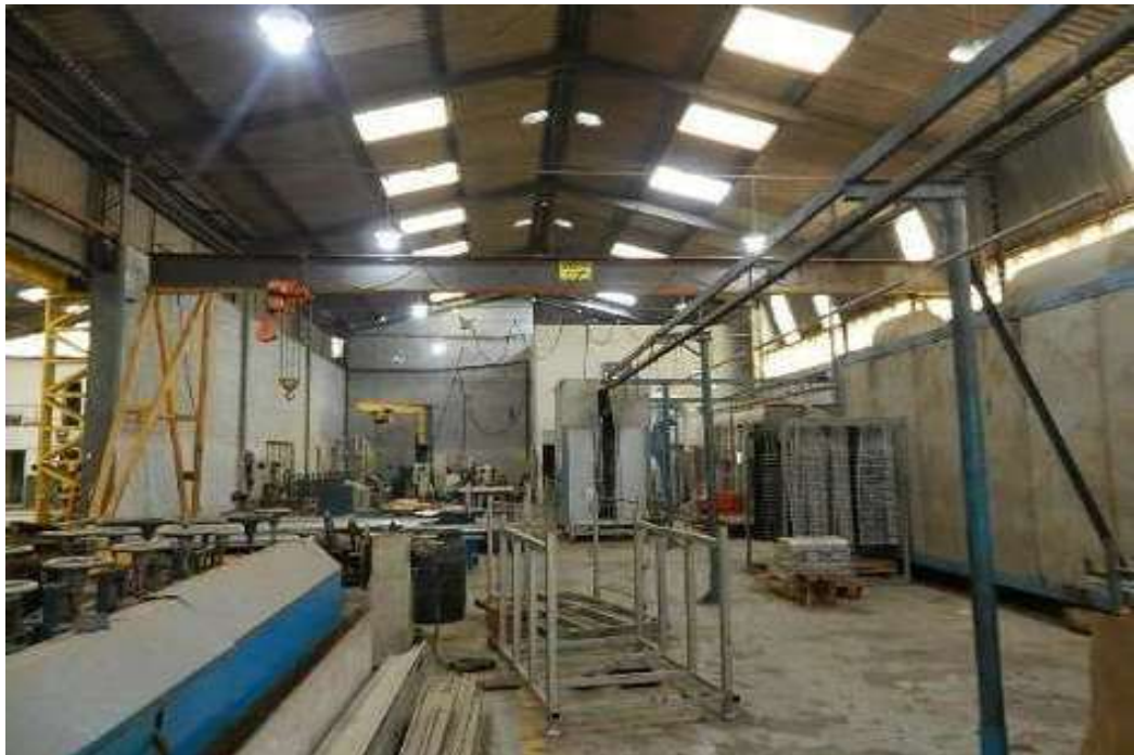
ITEM 1,004 - VISTA DO PORTICO MOVEL CAP: 4.000 KG COM TALHA ELETRICA COM TROLEY HOISTI JIB
