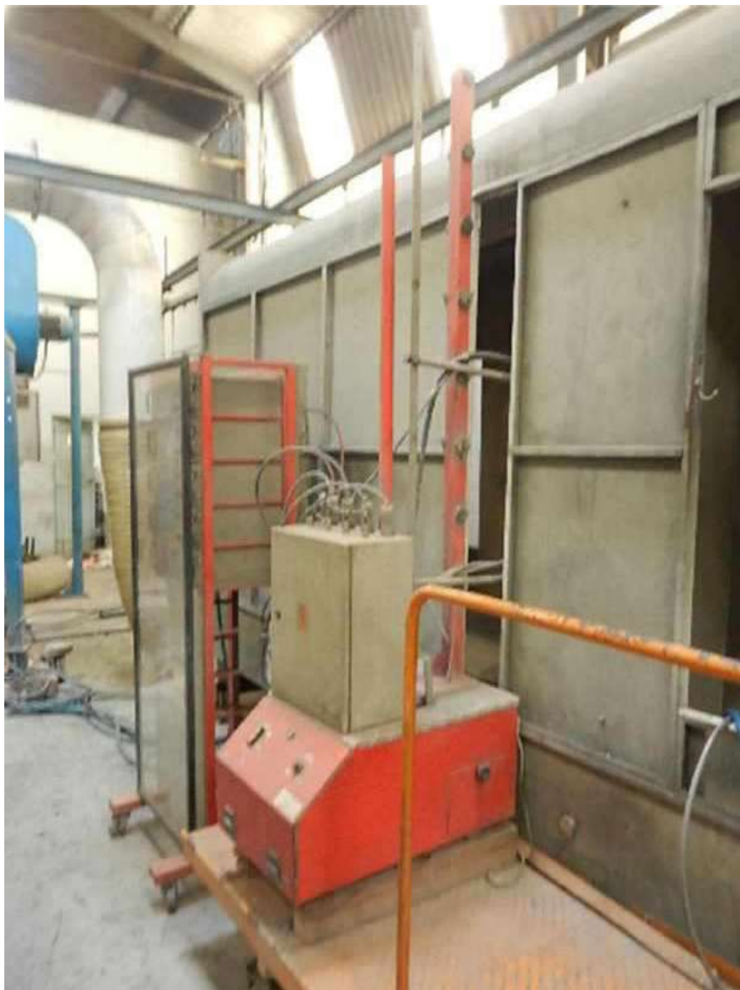
ITEM 1,038 - VISTA DA CABINE DE PINTURA MODELO: CPPE-ACGFD Nº 2367-003 DIM: 1.600 X 700 MM COM 4 BICOS MODELO: AUTOPLUS DA LINHA DE PINTURA A PO MARCA: ERZINGER,
