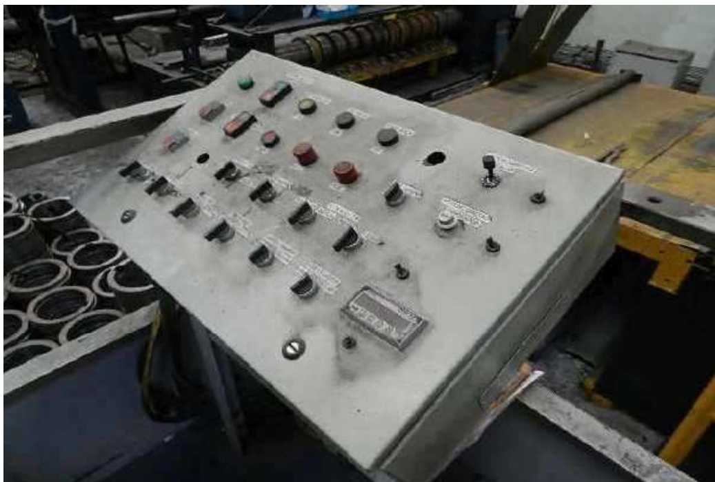
ITEM 1,022 - VISTA DA MESA DE COMANDO DOS EQUIPAMENTOS DA LINHA
