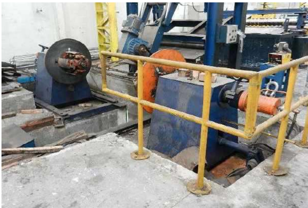
ITEM 1,022 - VISTA DO DESBOBINADOR DUPLO DA LINHA DE CORTE
