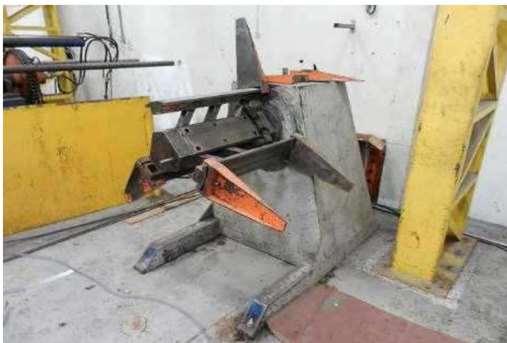
ITEM 1,014 - VISTA DO DESBOBINADOR
