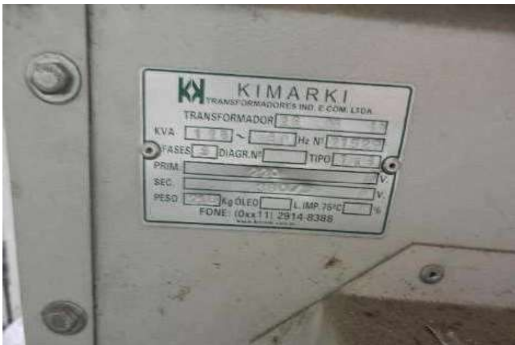
ITEM 1,027 - VISTA DA PLACA DE IDENTIFICAÇÃO DO TRANSFORMADOR ELETRICO CAP: 125 KVA MARCA: KIMARKI
