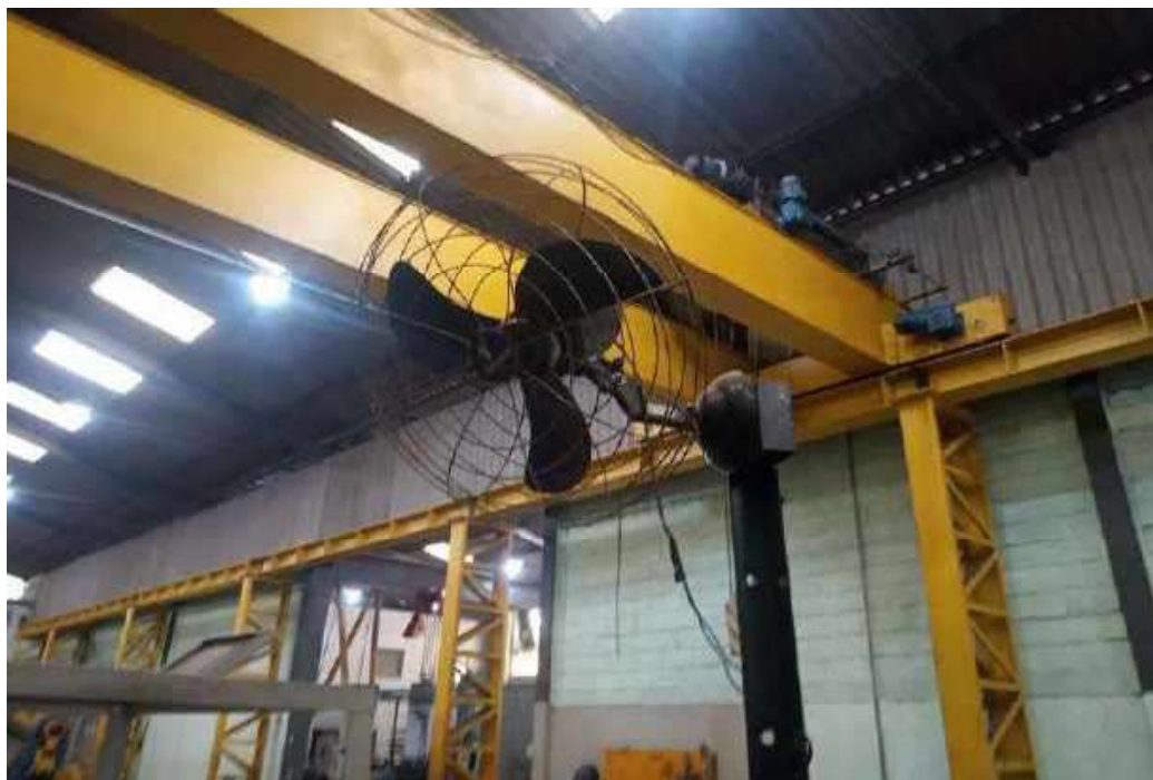
ITEM 2,003 - VISTA DO VENTILADOR DE PAREDE
