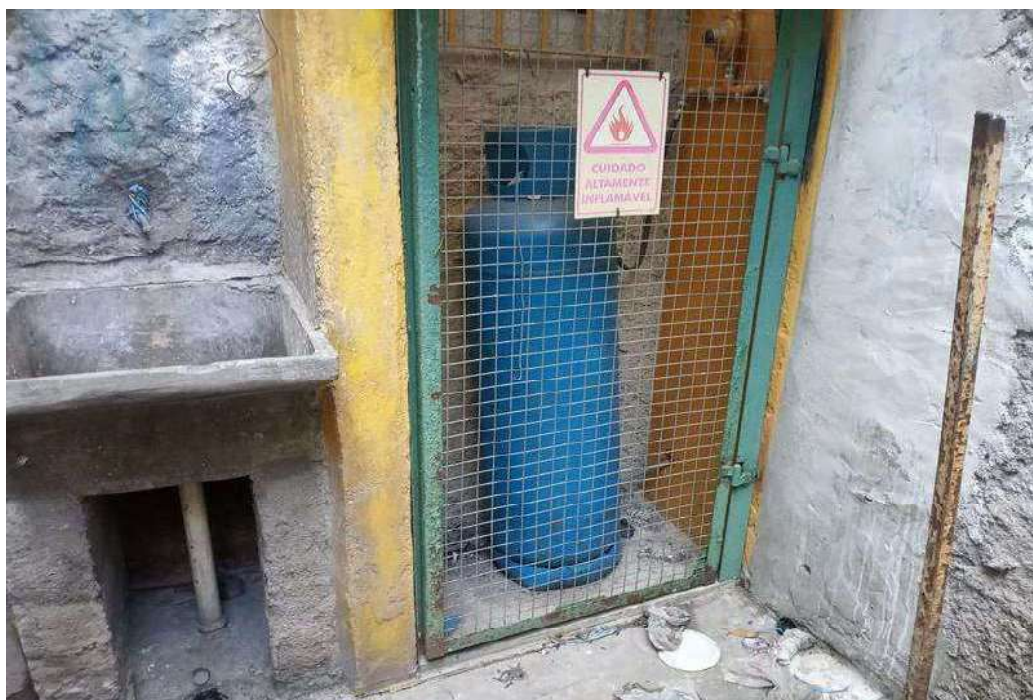
ITEM 2,007 - VISTA DO BOTIJÃO DE GÁS P45 ULTRAGÁS
