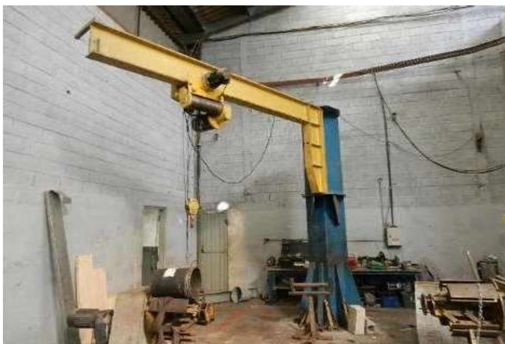
ITEM 1,042 - VISTA DO BRAÇO GIRATÓRIO COM TALHA ELETRICA MARCA: ROVELA COMANDO POR BOTOEIRA
