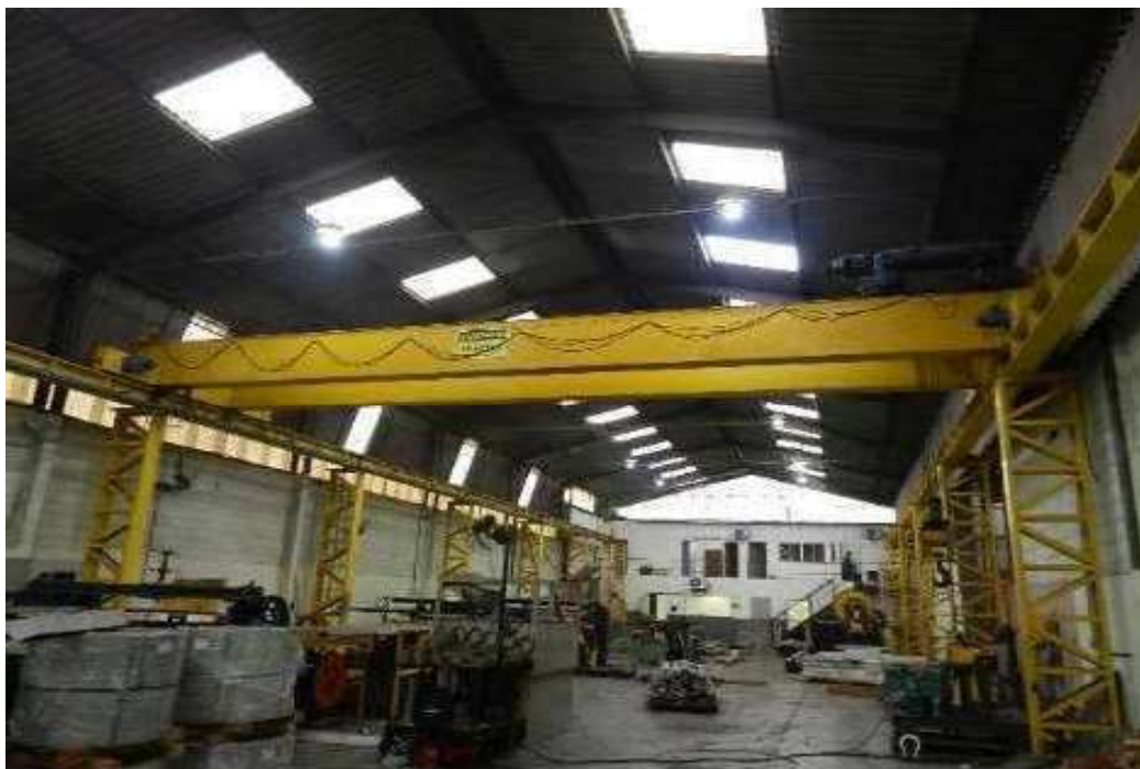
ITEM 1,037 - VISTA DA PONTE ROLANTE DUO VIGA CAP: 15 TON COM TALHA COM TROLEY MOTORIZADO COMANDO POR BOTOEIRA
