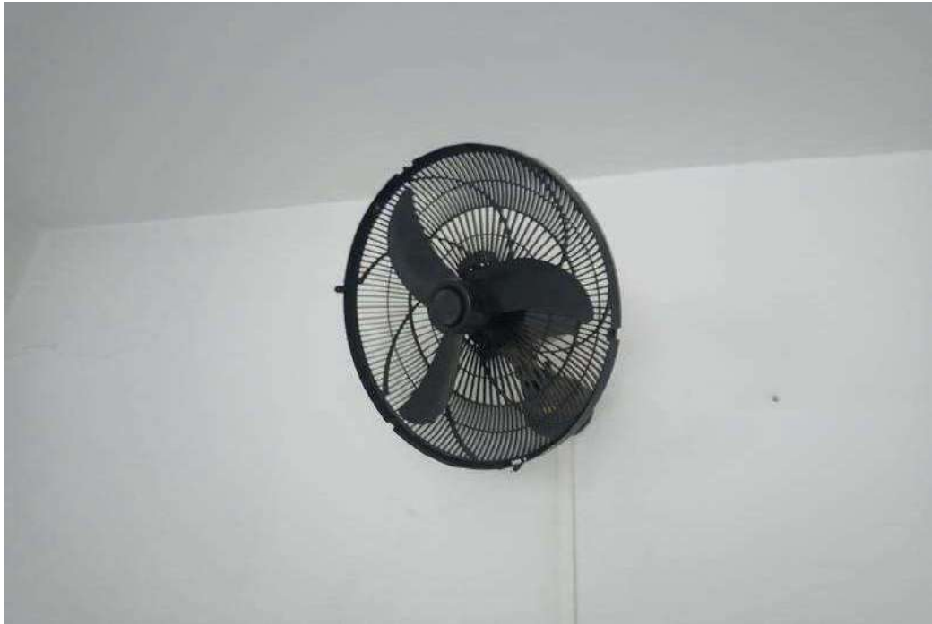
ITEM 2,005 - VISTA DO VENTILADOR DE PAREDE
