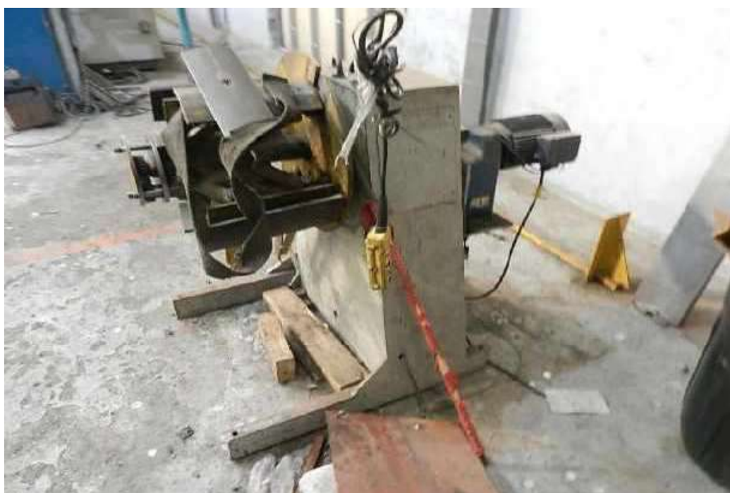
ITEM 1,043 - VISTA DA MAQ Nº 3 - COMPREENDENDO: DESBOBINADOR ACIONADO POR MOTOR E REDUTOR, PAINEL DE COMANDO, PERFILADEIRA COM 14 CASTELOS
