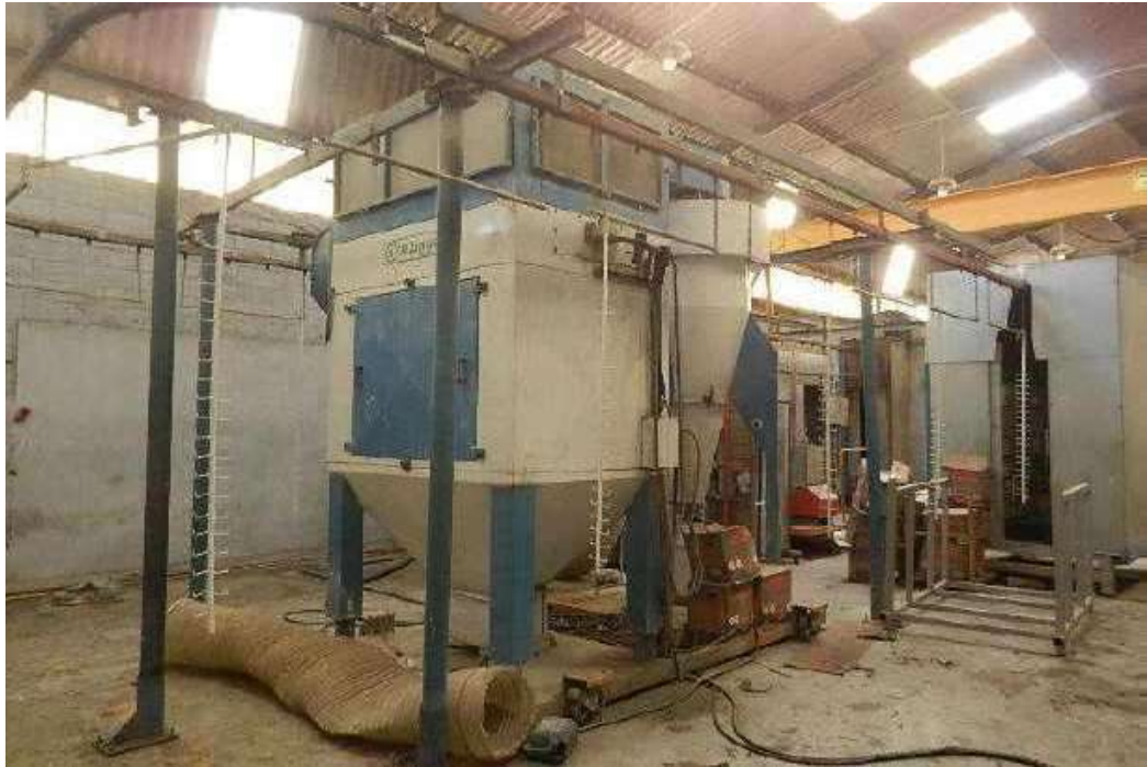
ITEM 1,038 - VISTA DO SISTEMA DE CAPTAÇÃO DE PO COM FILTRO E CICLONE DA LINHA DE PINTURA A PO MARCA: ERZINGER
