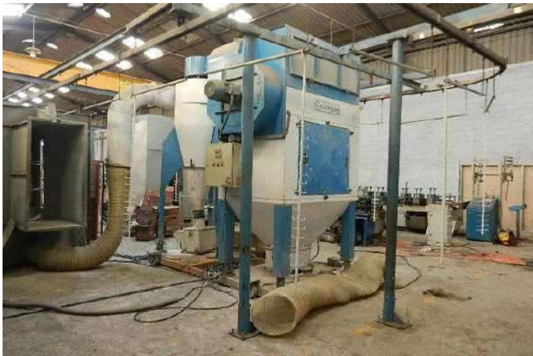
ITEM 1,038 - VISTA DO SISTEMA DE CAPTAÇÃO DE PO COM FILTRO E CICLONE DA LINHA DE PINTURA A PO MARCA: ERZINGER
