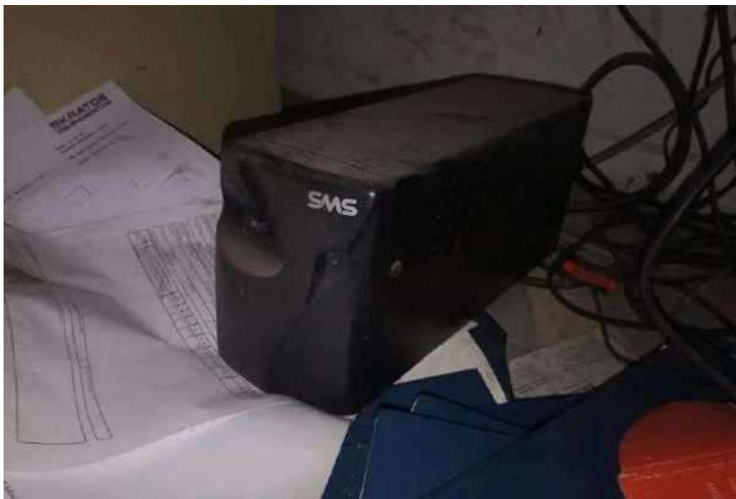
ITEM 3,047 - VISTA DO ESTABILIZADOR MARCA: SMS MOD: PROGRESSIVE III AP200S
