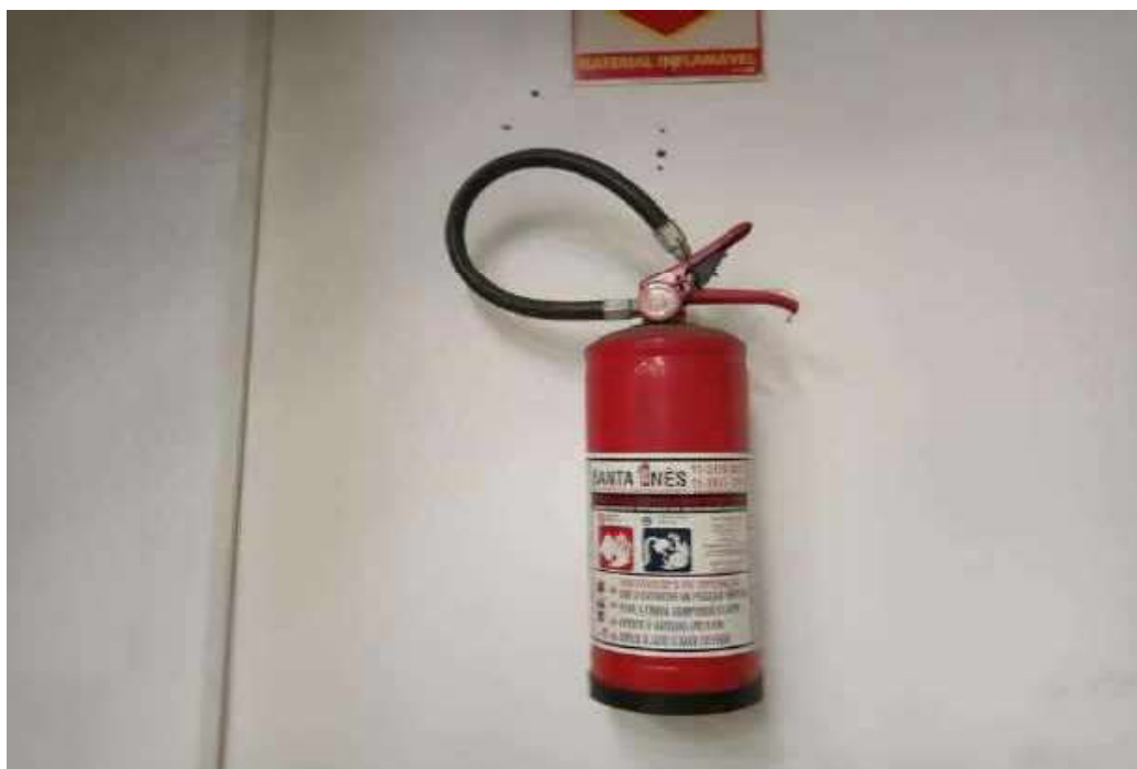
ITEM 4,001 - VISTA DO EXTINTOR
