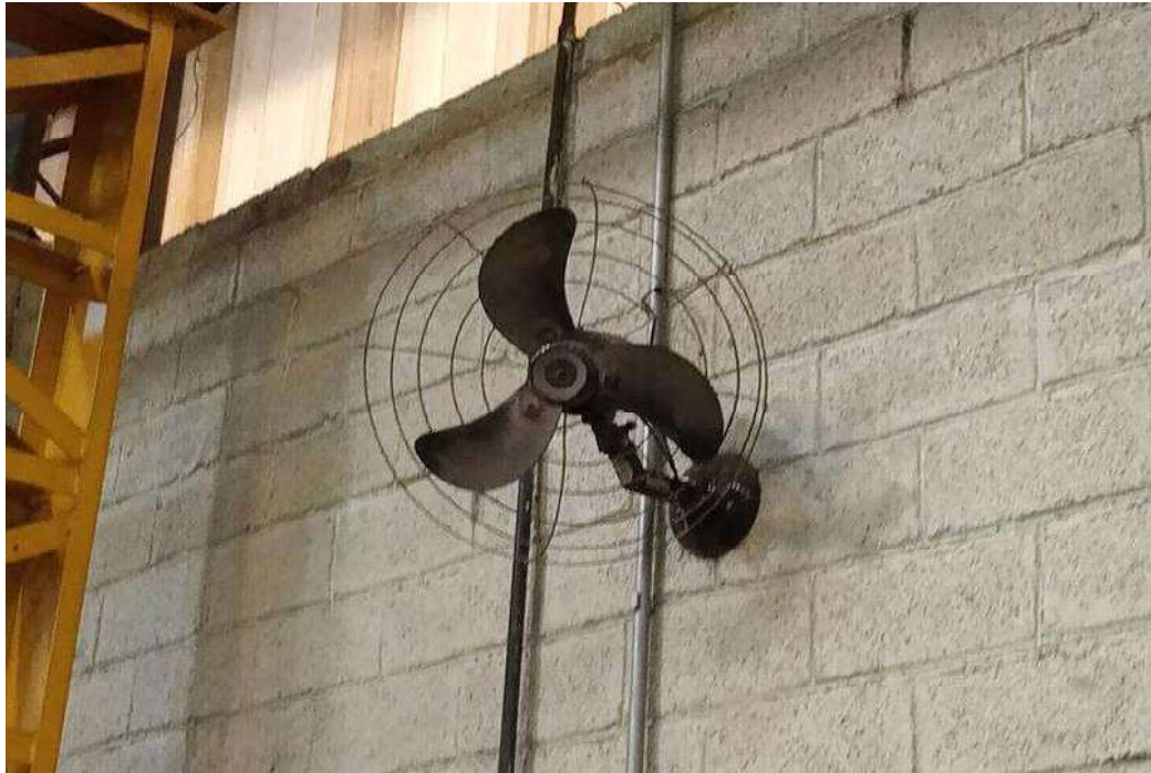
ITEM 2,001 - VISTA DO VENTILADOR DE PAREDE
