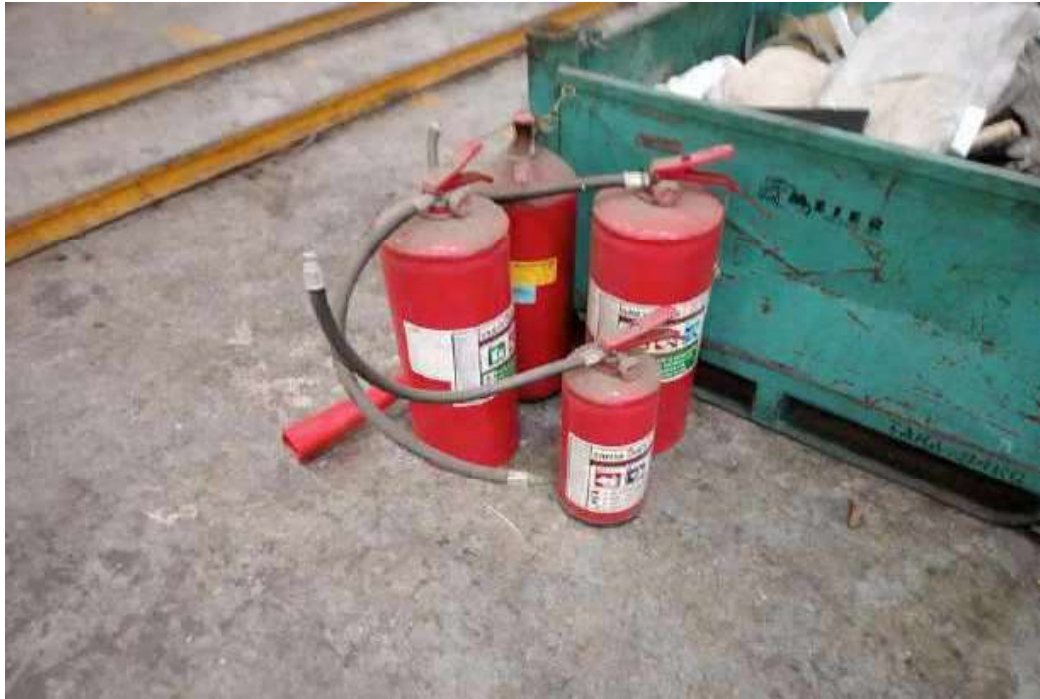
ITEM 4,002 - VISTA DO EXTINTOR
