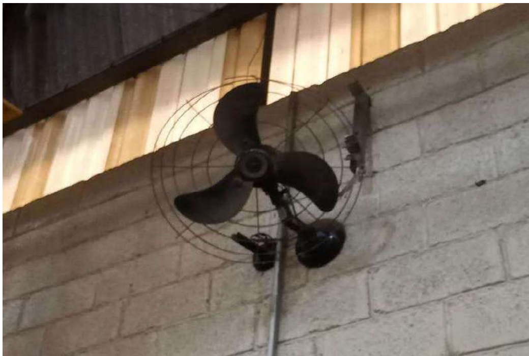
ITEM 2,002 - VISTA DO VENTILADOR DE PAREDE
