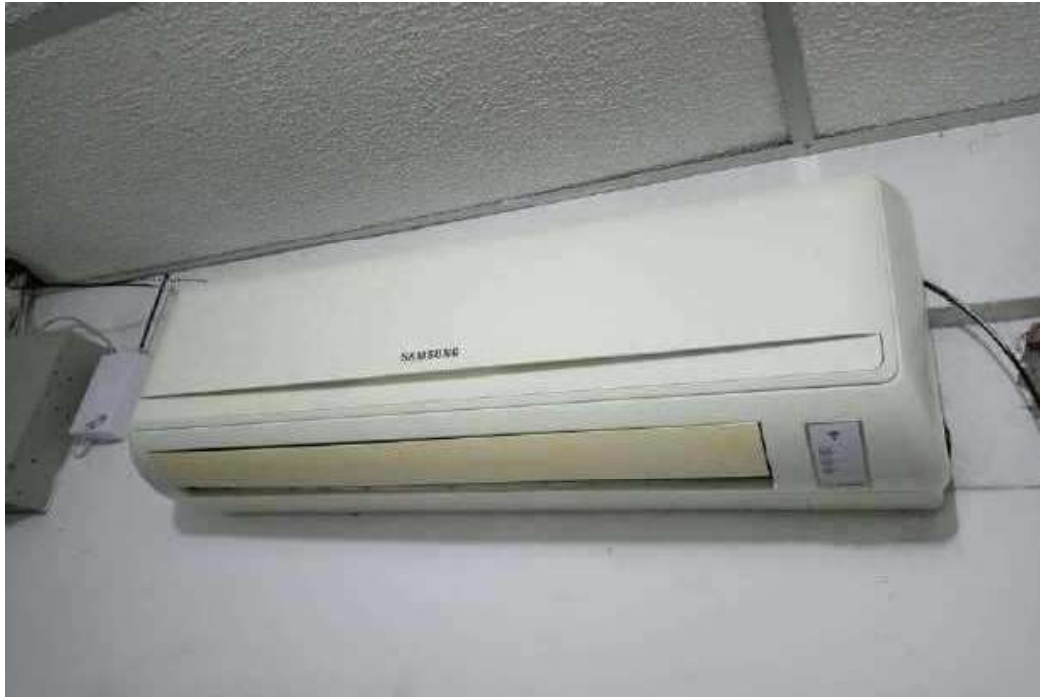
ITEM 2,015 - VISTA DO AR CONDICIONADO 12.000 BTUS MARCA: SAMSUNG MOD: AS12UBANXAZ
