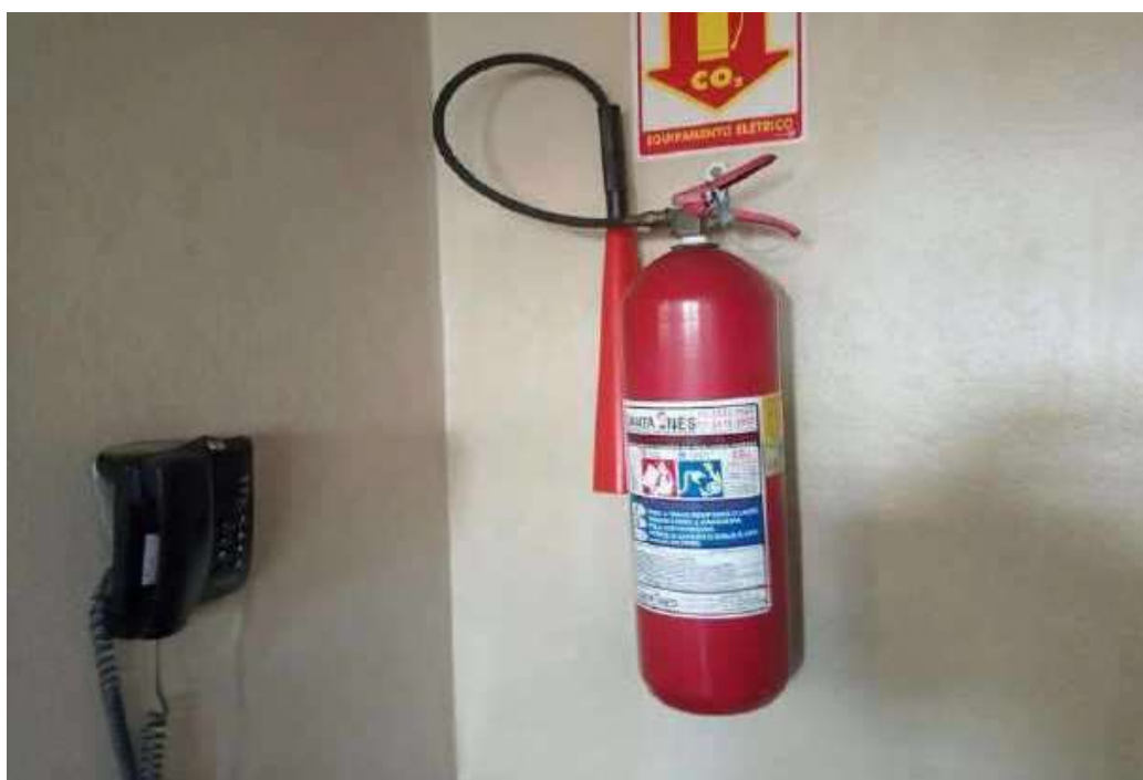
ITEM 4,010 - VISTA DO EXTINTOR
