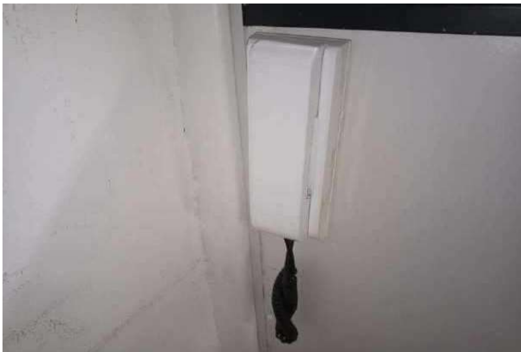
ITEM 2,012 - VISTA DO INTERFONE
