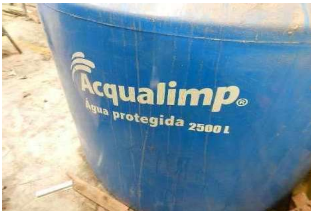
ITEM 1,032 - VISTA DO TANQUE DE ÁGUA CAP: 2.500 L MARCA: ACQUALIMP
