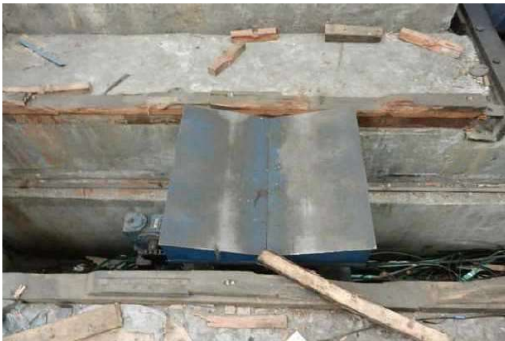
ITEM 1,022 - VISTA DO CARRO PARA ALIMENTACAO DE BOBINA DA LINHA DE CORTE
