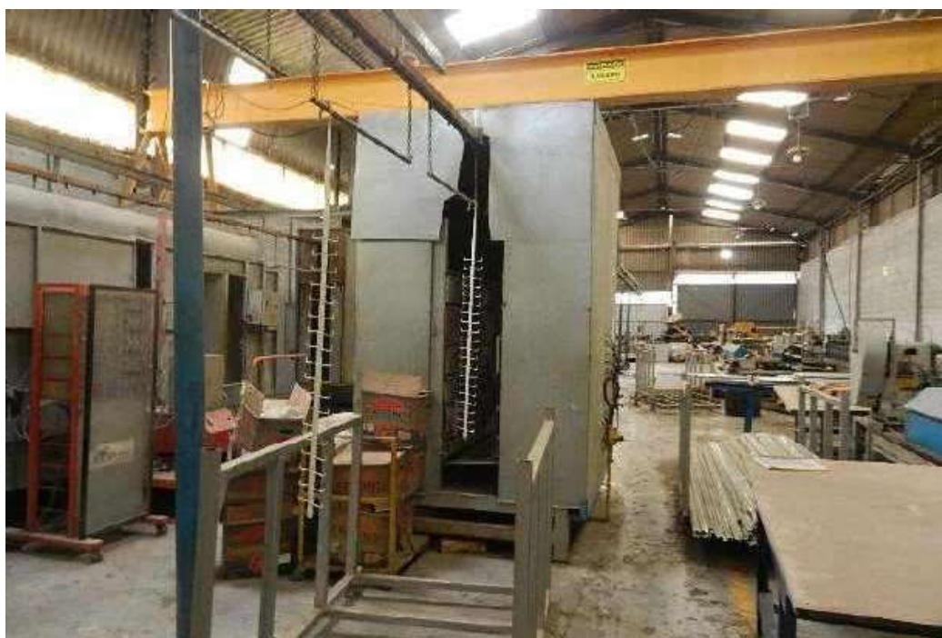
ITEM 1,038 - VISTA ESTUFA DE SECAGEM COM 2 CAMARAS DA LINHA DE PINTURA A PO MARCA: ERZINGER
