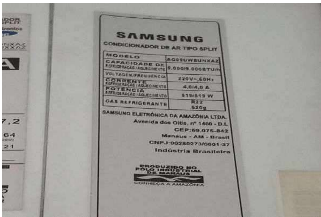
ITEM 2,025 - VISTA DA PLACA DE IDENTIFICAÇÃO DO AR CONDICIONADO 9.000 BTUS MARCA: SAMSUNG MOD: AQ09UWBUNXAZ
