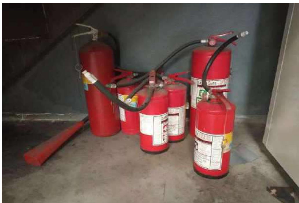
ITEM 4,001 - VISTA DO EXTINTOR
