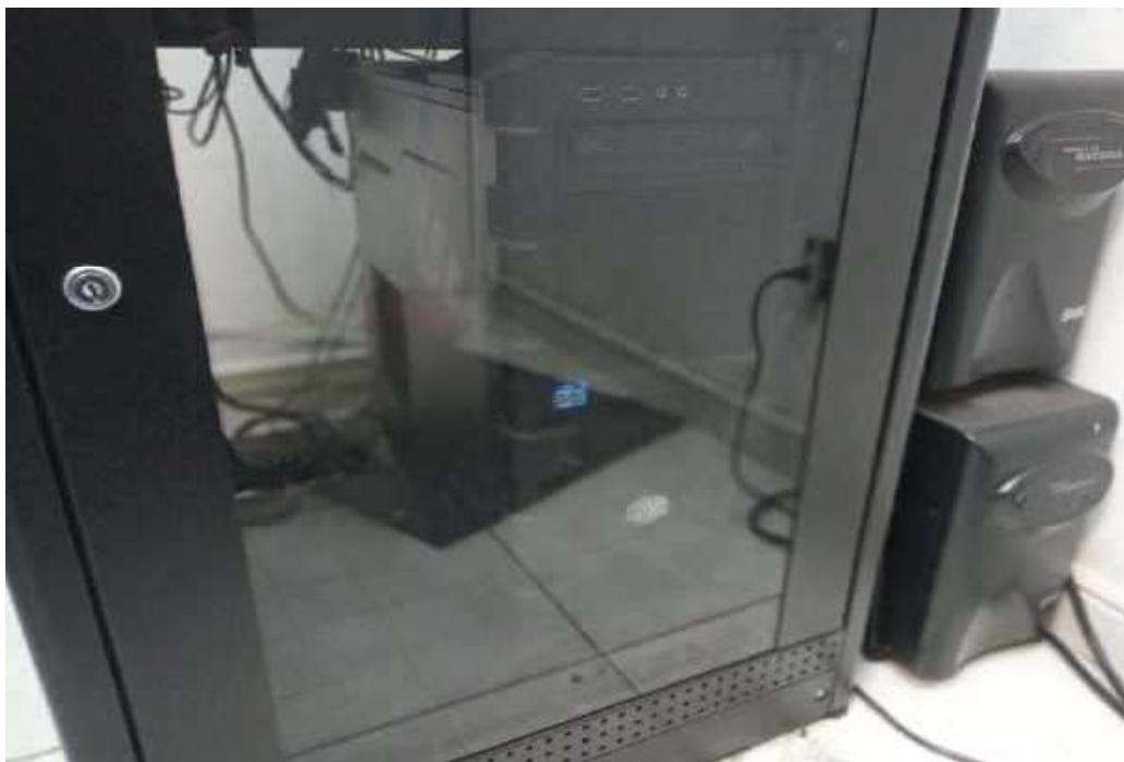
ITEM 3,042 - VISTA DO SERVIDOR COOLER MASTER XEON
